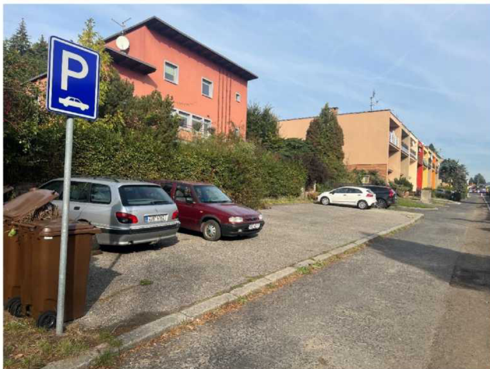
Stav chodníku a komunikace ulice Janáčkova
