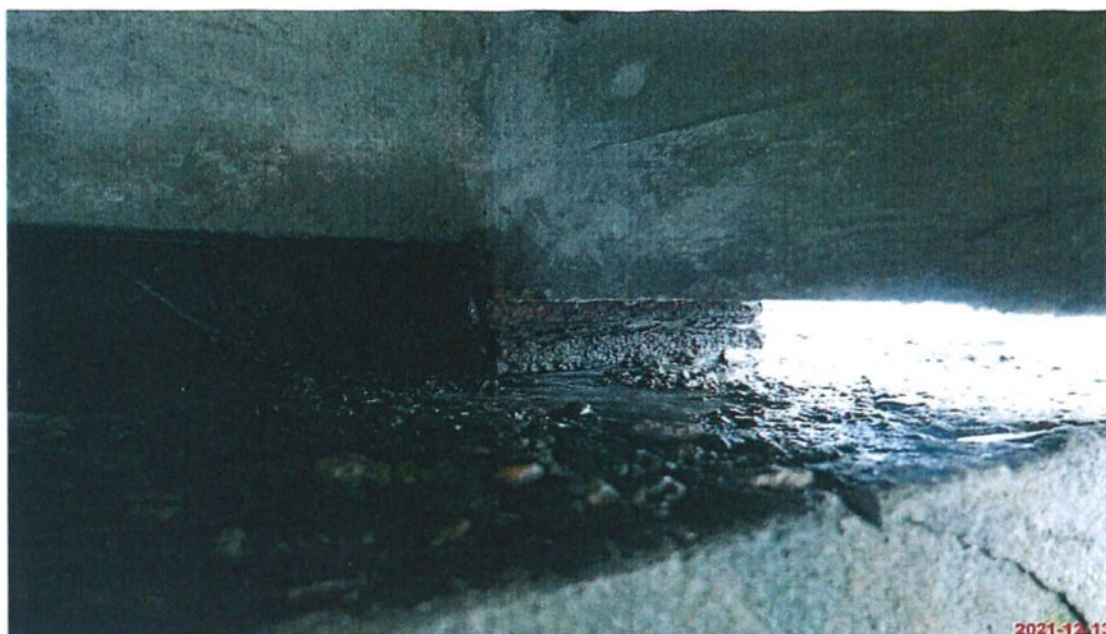
Stav ložisek – plátková koroze
