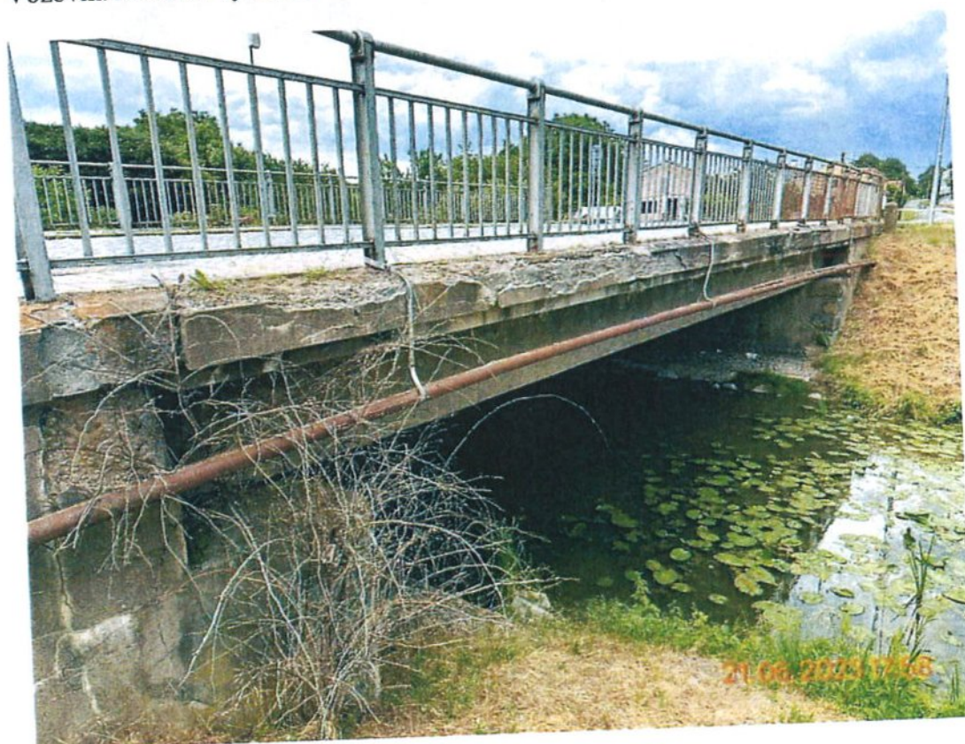
Degradace říms a spodní stavby
