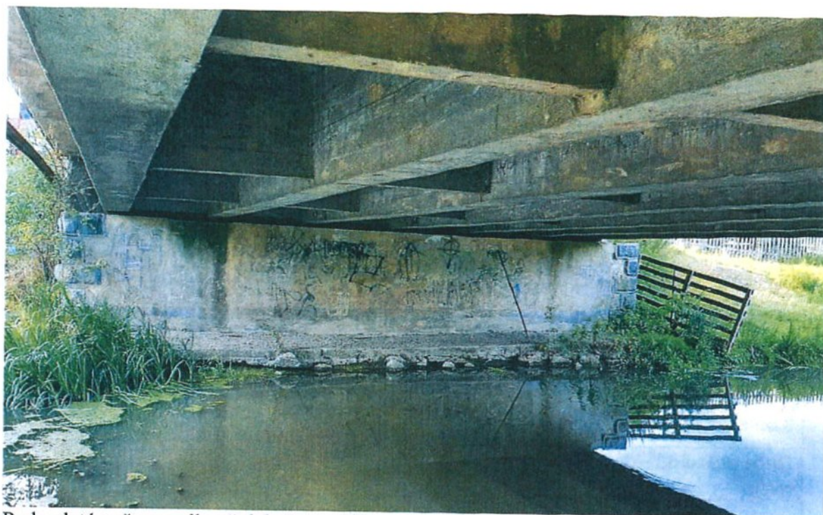
Podemletá opěra a celkově dobrý stav NK
