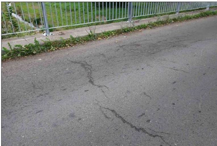
trhliny v krytu vozovky
