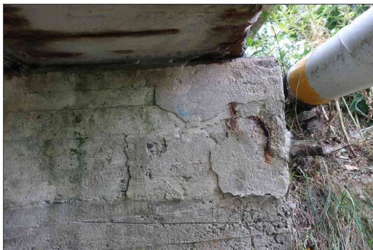
opěra 1 - degradace betonu
