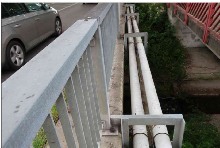
chráničky IS podél pravé římsy
