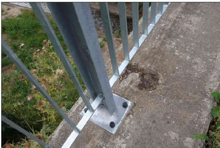
nezasnovaná místa po zabetonovaných sloupcích původního zábradlí
