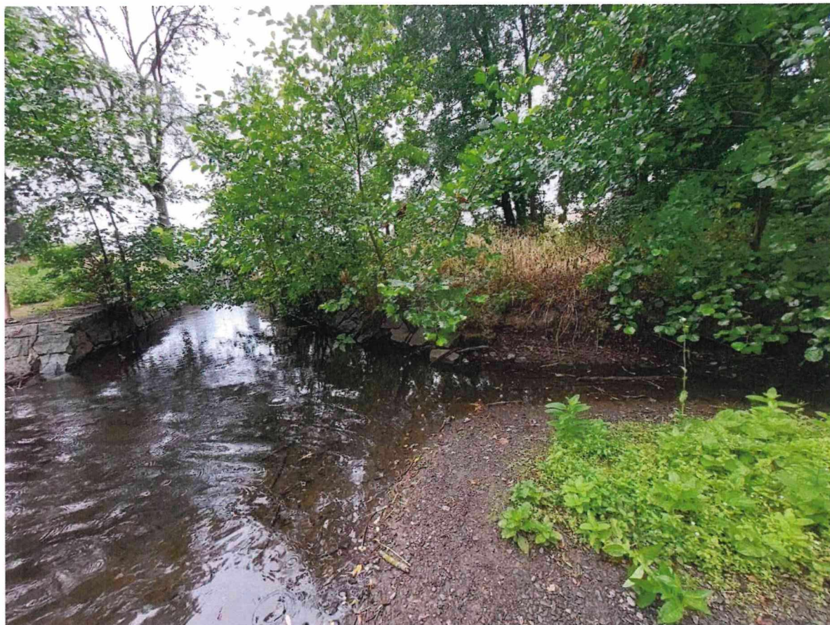
Foto č. 3: Pohled na nátok do obecního náhonu a poškozené opevnění PB
