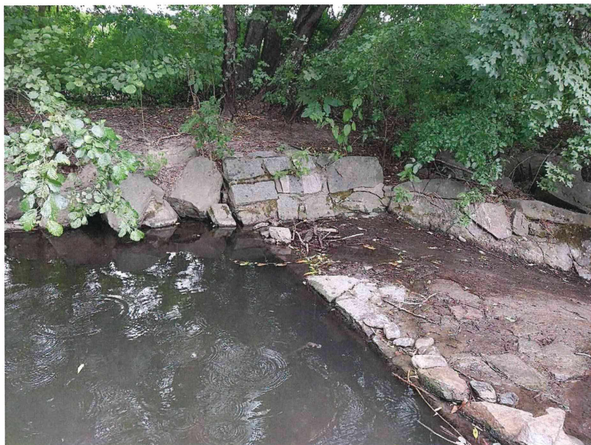
Foto č.4: Pohled na LB s poškozeným opevněním břehu, poškozený práh přelivné hrany jezu
