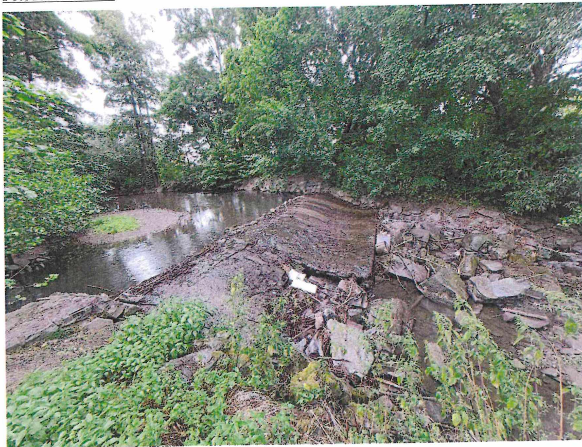
Foto č.1: Pohled z PB na poškozený jez
