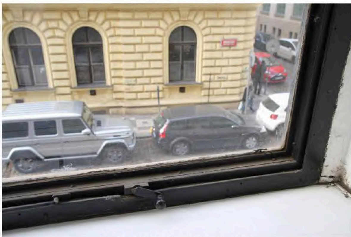
Obrázek 42: Okno v místnosti M7 – detail
