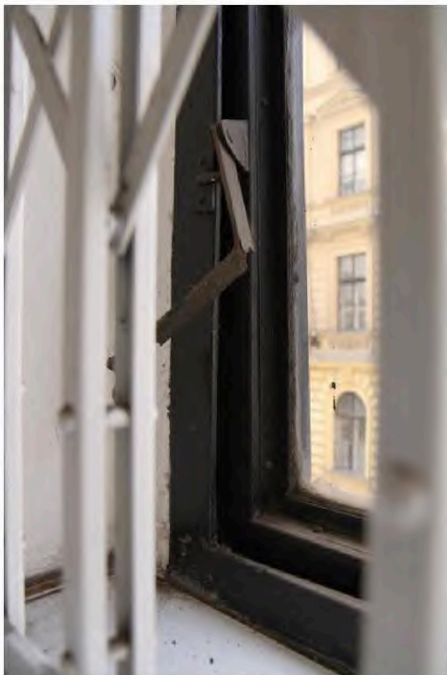
Obrázek 55: Okno v místnosti M9 - detail poškození
