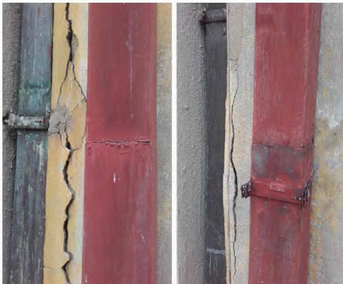
Obrázek 25: Havarijní stav omítky v okolí okapů
