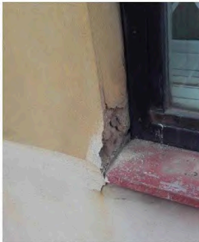
Obrázek 29: Detail poškození okenního ostění
