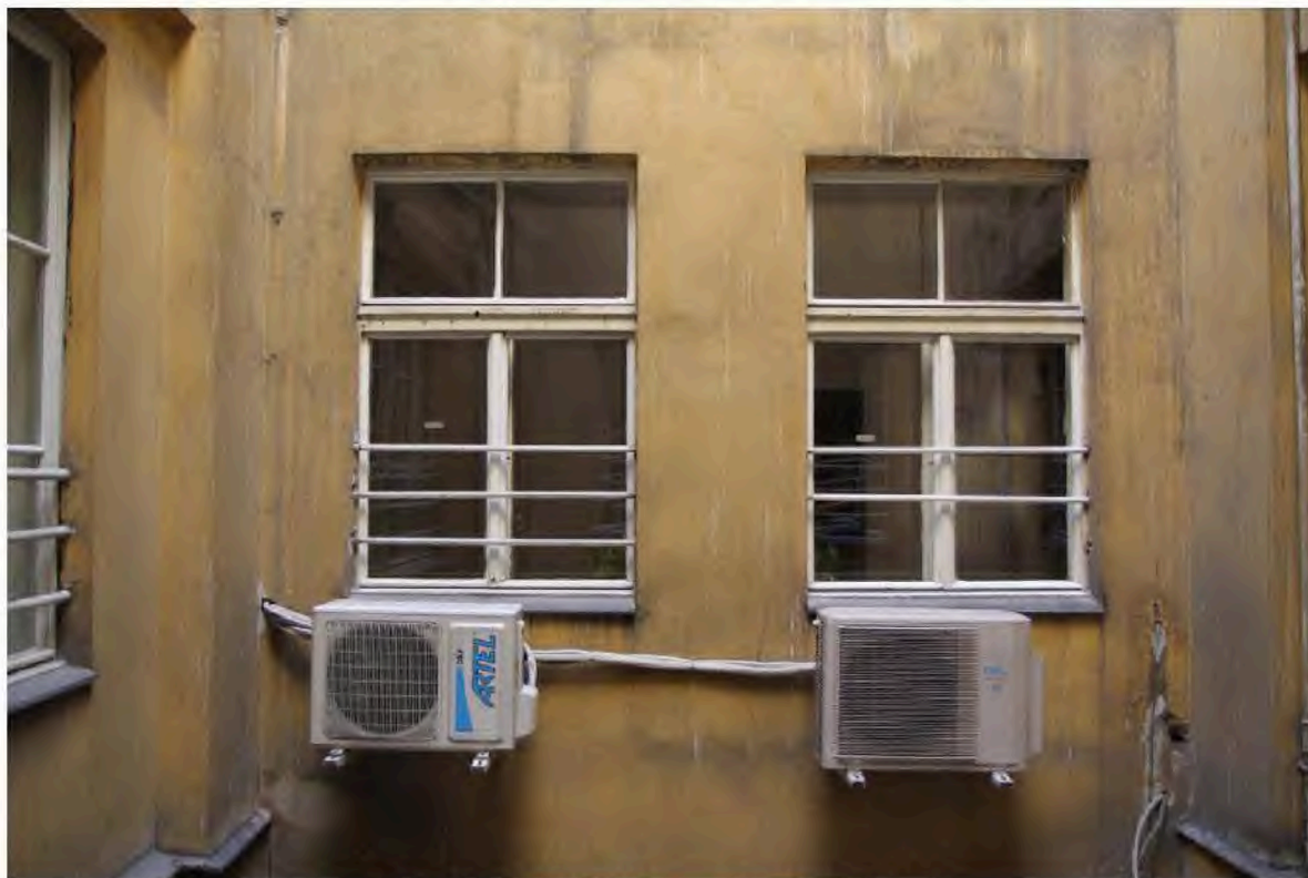
Obrázek 43: Detail stavu omítek světlíku č. 2
