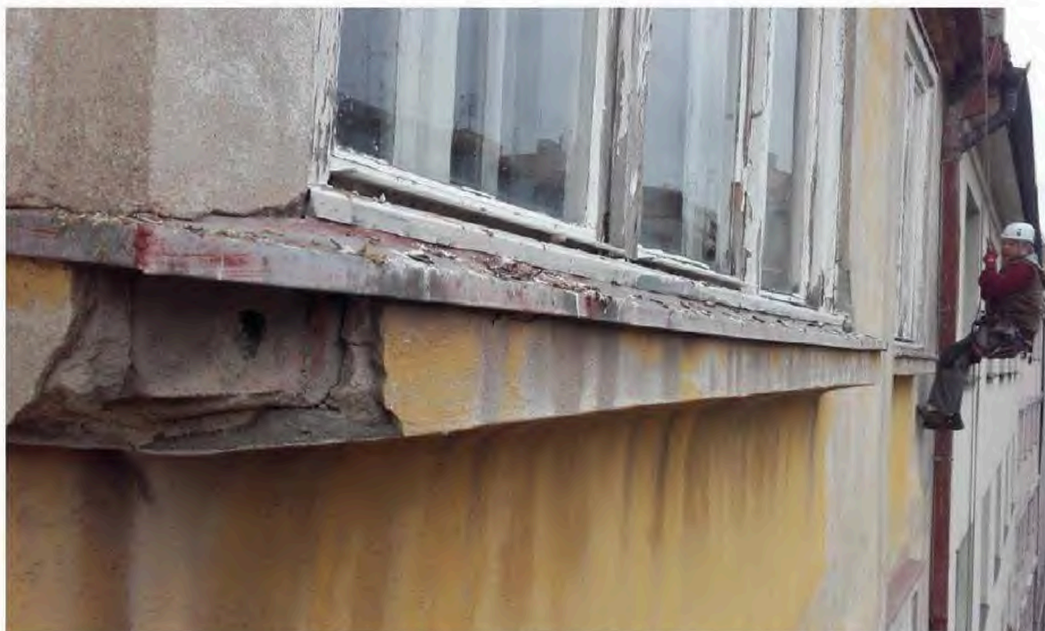
Obrázek 30: Detail poškození parapetu okna
