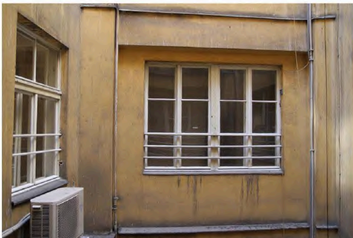
Obrázek 44: Detail stavu omítek světlíku č. 2
