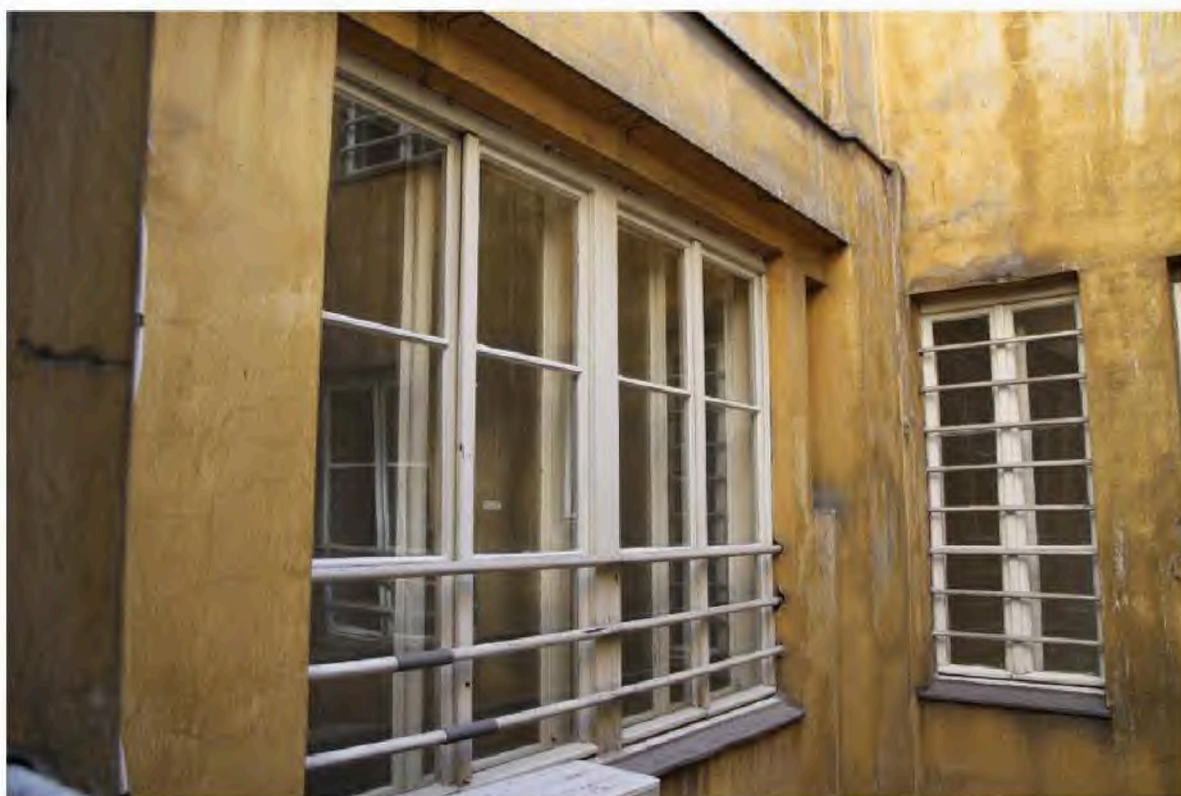
Obrázek 41: Detail stavu omítek světlíku č. 2
