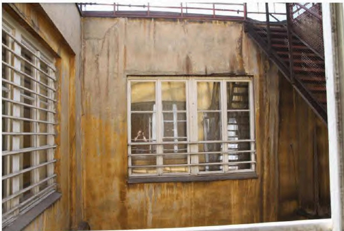
Obrázek 36: Detail stavu omítek světlíku č. 2
