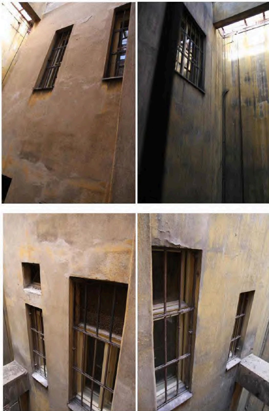
Obrázek 34: Detaily stavu omítek světlíku č. 1
