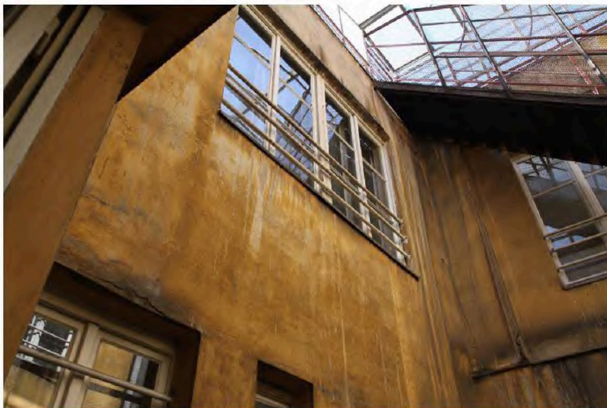
Obrázek 45: Detail stavu omítek světlíku č. 2
