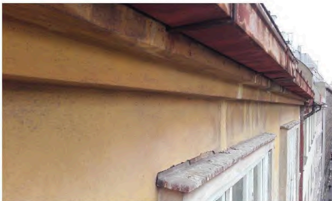
Obrázek 26: Detail stavu korunní římsy a nadpraží okna
