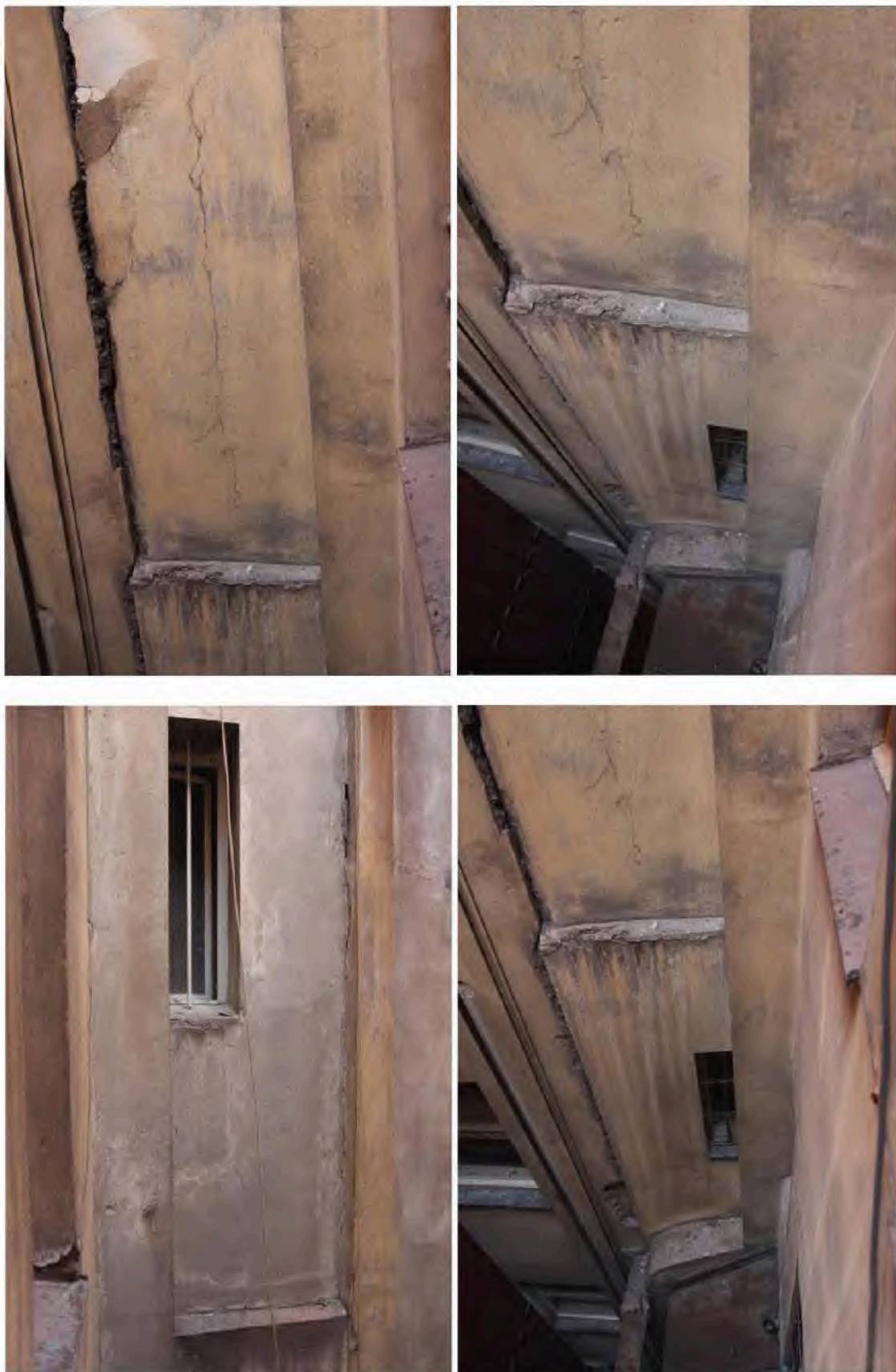
Obrázek 55: Detaily stavu omítek světlíku č. 3
