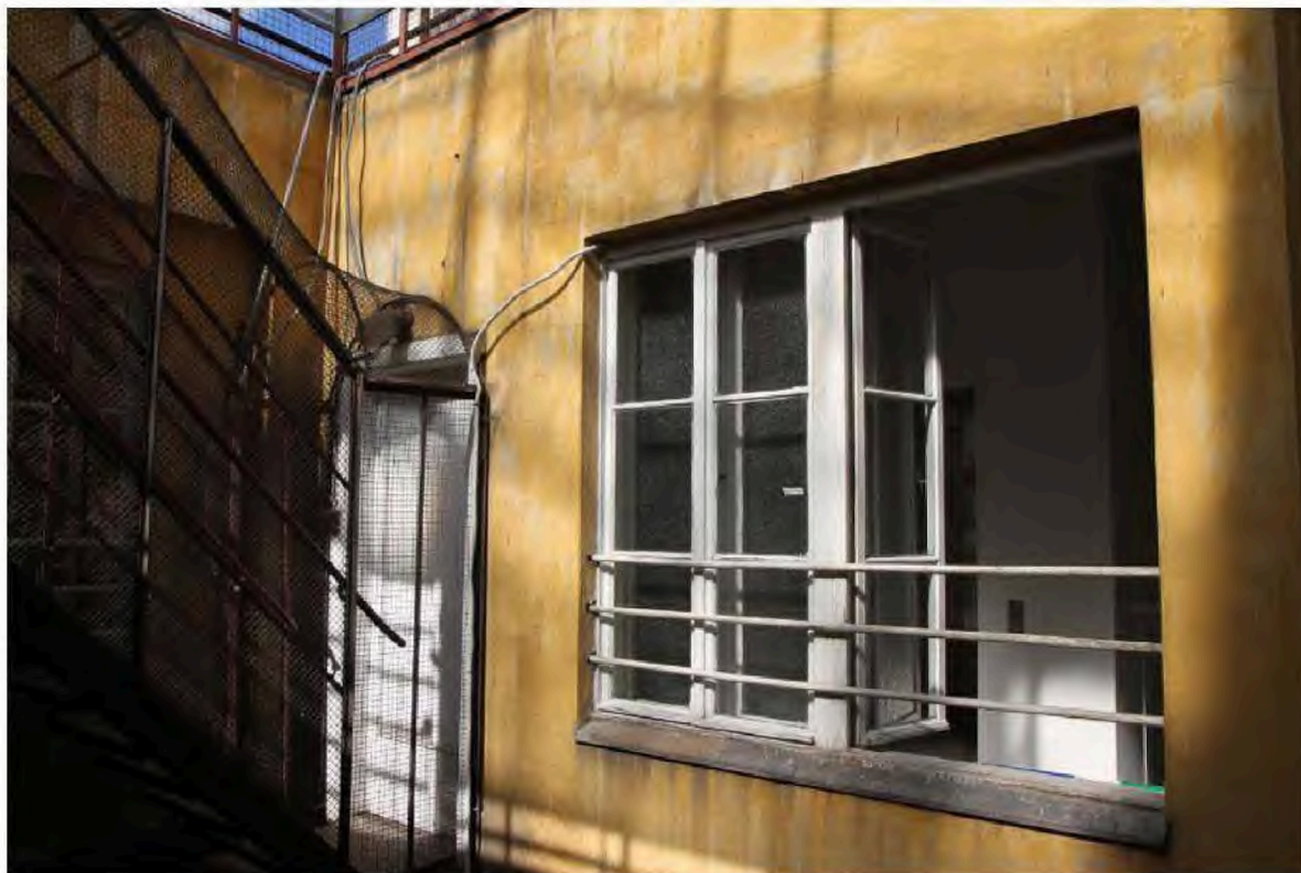
Obrázek 47: Detail stavu omítek světlíku č. 2
