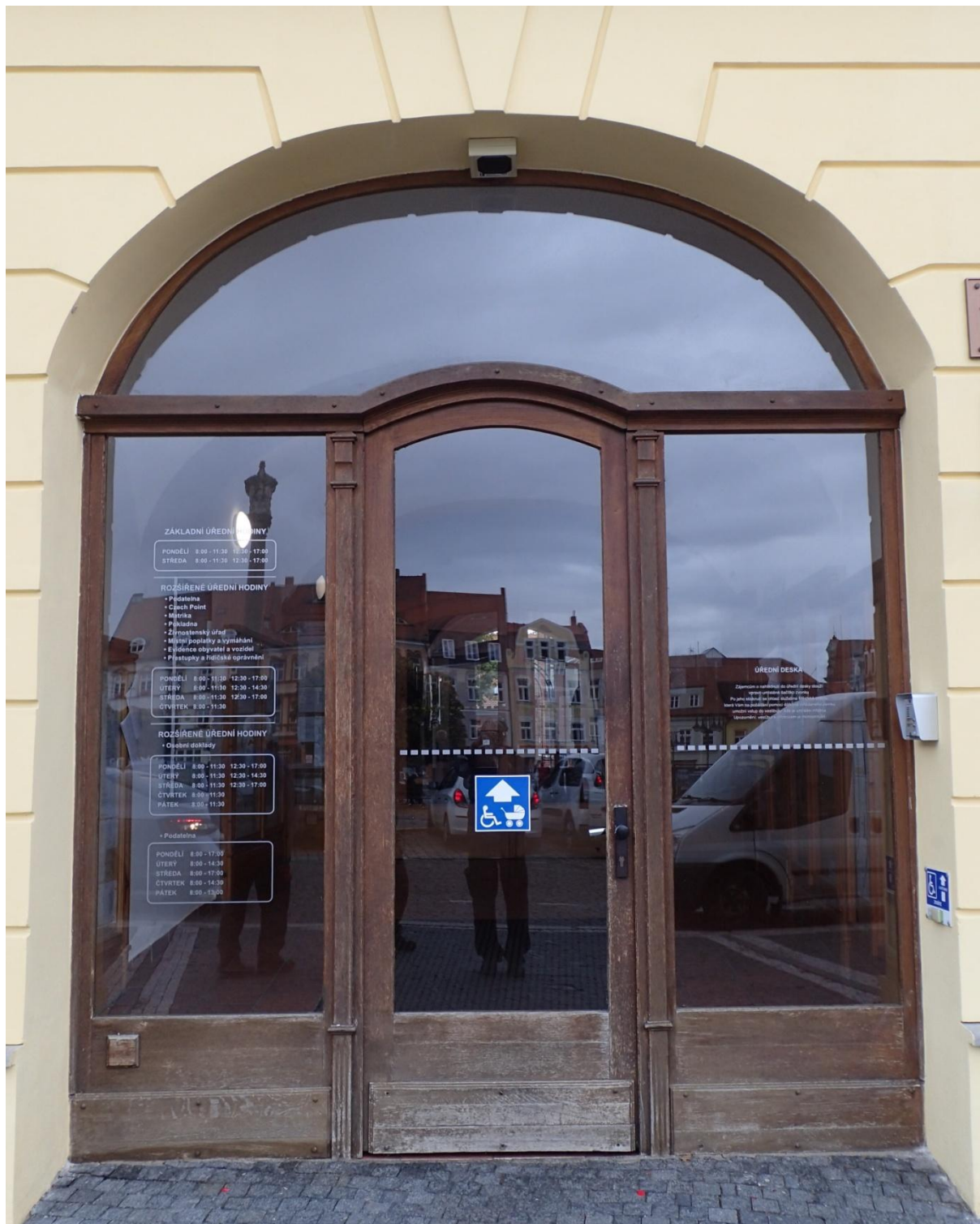
Obr. č. 19 Stav při průzkumu – dveře /infocentrum/ 1. NP – vnější strana – celkový pohled Konstrukčně jsou dveře v pořádku, povrchová úprava je dožilá. Barevná lazura se hlavně ve spodní části uvolňuje a odpadá. Pouteč je jednoduše profilovaný. Zasklení je pevné. U okopových desek upevněných vruty jsou vypadané záslepky.
