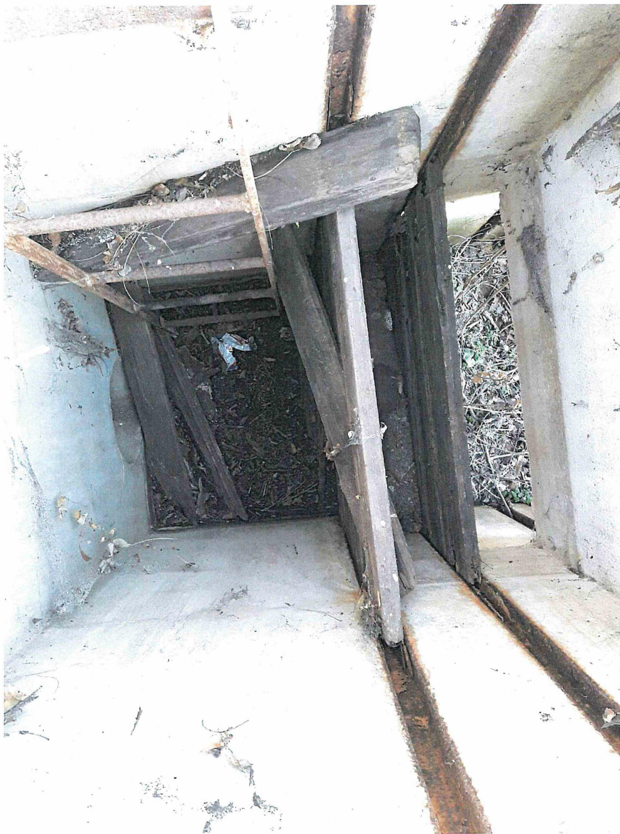
Obr. č. 5: Vnitřní prostor požeráku, degradované dluže, koroze na ocelových konstrukcích
