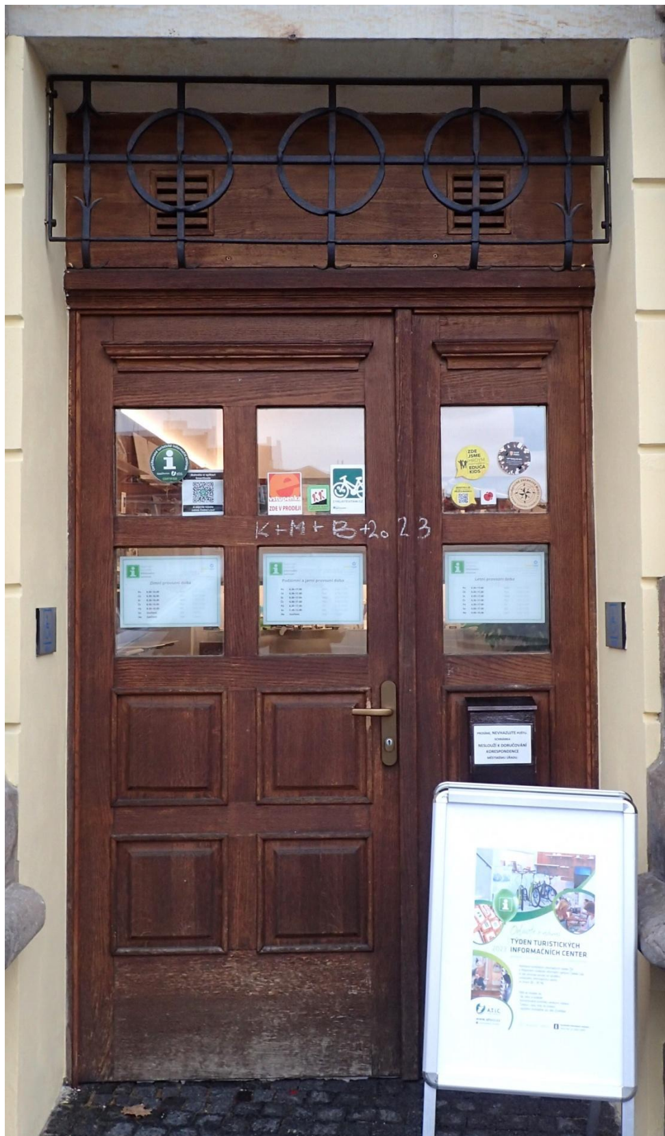
Obr. č. 22 Stav při průzkumu – dveře - 1. NP – vnější strana – celkový pohled Konstrukčně jsou dveře v pořádku, povrchová úprava je dožilá. Barevná lazura se hlavně ve spodní části uvolňuje a odpadá. Poutec je jednoduše profilovaný.
