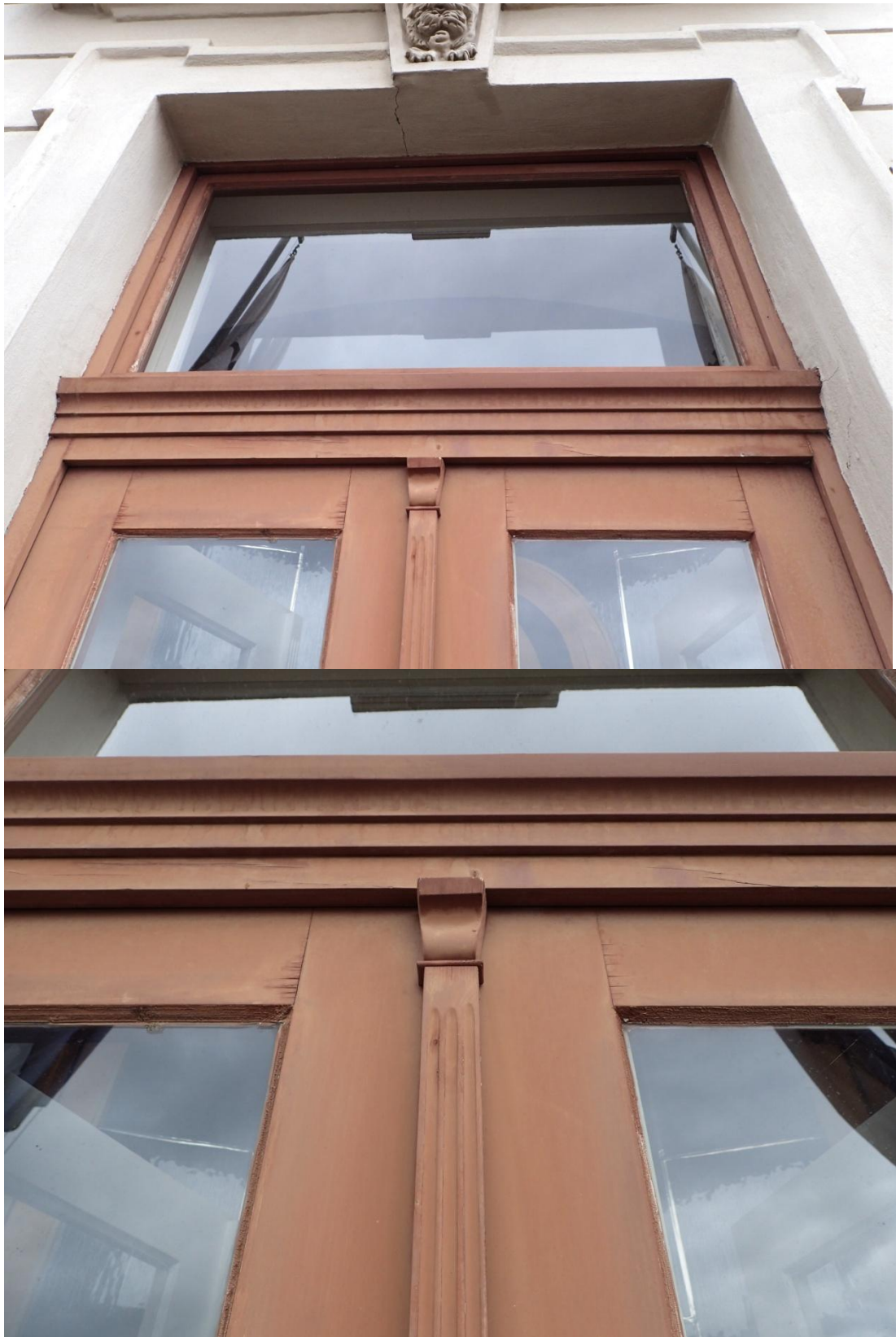
Obr. č. 6+7 Stav při průzkumu – dveře 2. NP – vnější strana – detail – horní část Konstrukčně jsou dveře v pořádku, povrchová úprava je dožilá. Barevný krycí nátěr se hlavně ve spodní části uvolňuje a odpadá. Ve spojích je barva popraskaná. Dobře patrný je poutec a příklopná lišta s hlavicí.
