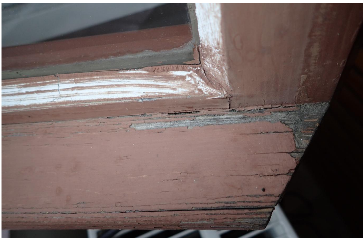
Obr. č. 26+27 Stav při průzkumu – okna /infocentrum/ 1. NP – vnější strana – detail Barevný nátěr je hlavně ve spodní části popraskaný, částečně nesoudržný a na namáhaných místech často chybí. Nesoudržné vrstvy bude nutné odstranit.
