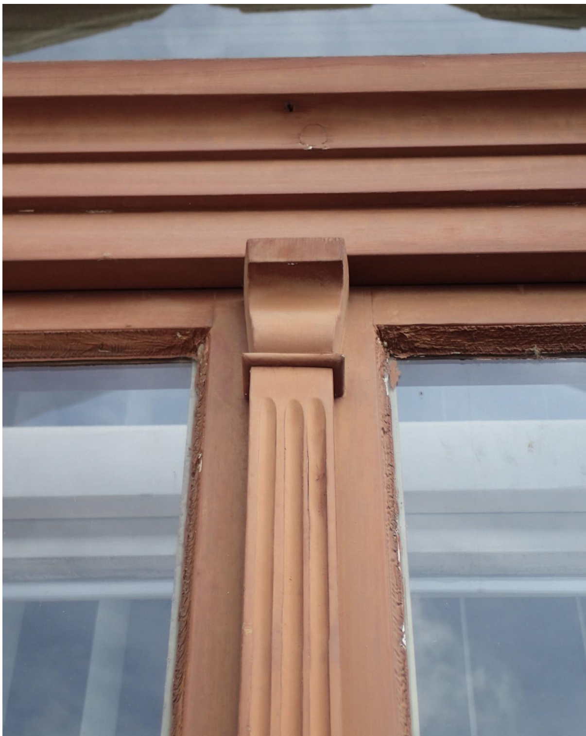
Obr. č. 3 Stav při průzkumu – okno 1. NP – vnější strana – detail Pohled na horní část okna s hlavicí příklopné lišty s kanelurami. Poškozená je povrchová úprava, která je dožilá a vyšisovaná.
