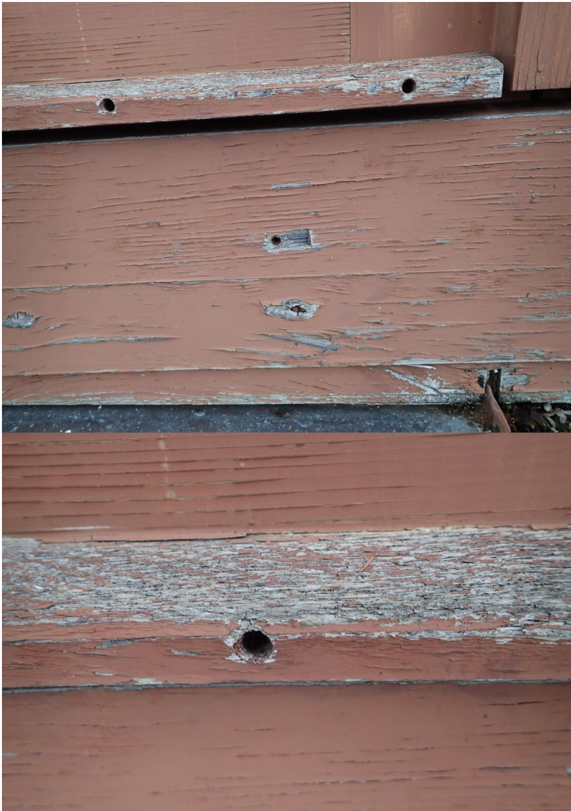
Obr. č. 10+11 Stav při průzkumu – dveře 2. NP – vnější strana – detail – spodní část Povrchová úprava je dožilá. Barevný krycí nátěr se hlavně ve spodní části uvolňuje a odpadá. Ve spojích je barva popraskaná. Dobře patrný je stav okapniček a soklové části dveří, kde jsou vypadané záslepky vrutů.
