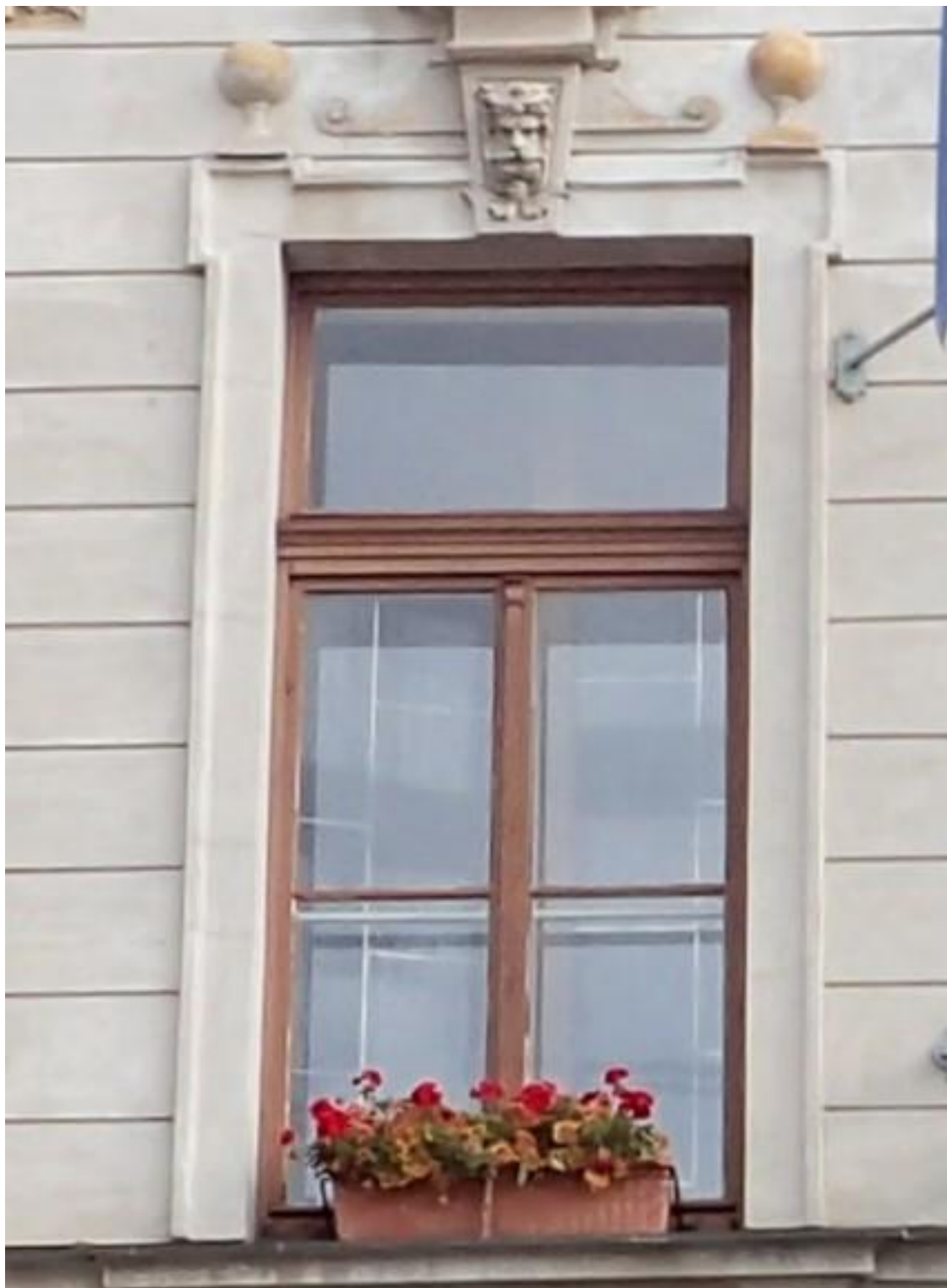
Obr. č. 4 Stav při průzkumu – okno 2. NP – vnější strana – celkový pohled Celkový pohled na okno z náměstí v 2. NP. Konstrukčně je okno v pořádku, povrchová úprava je dožilá. Barevný krycí nátěr se hlavně ve spodní části uvolňuje a odpadá. Stav je podobný jako u oken v 1 np.
