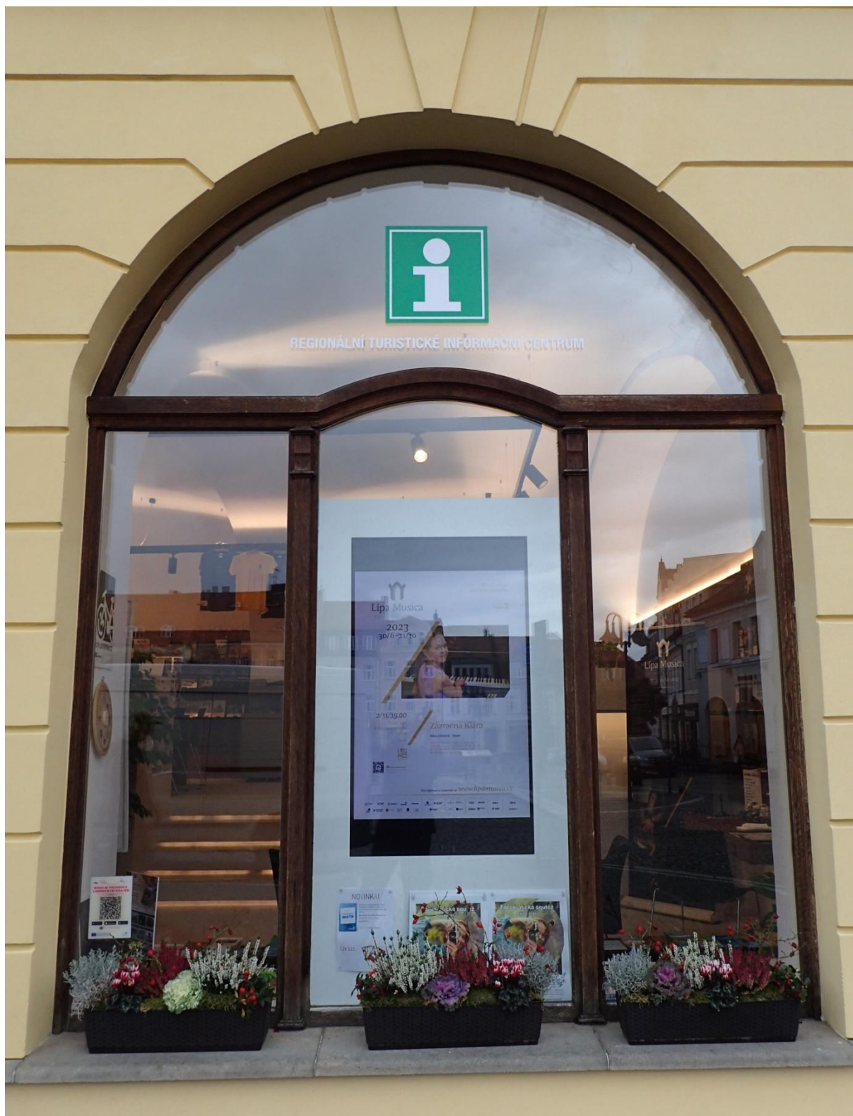
Obr. č. 18 Stav při průzkumu – okno 1. NP – vnější strana – celkový pohled Konstrukčně je okno v pořádku, povrchová úprava je dožilá. Barevná lazura se hlavně ve spodní části uvolňuje a odpadá. Poutec je jednoduše profilovaný. Zasklení je pevné.
