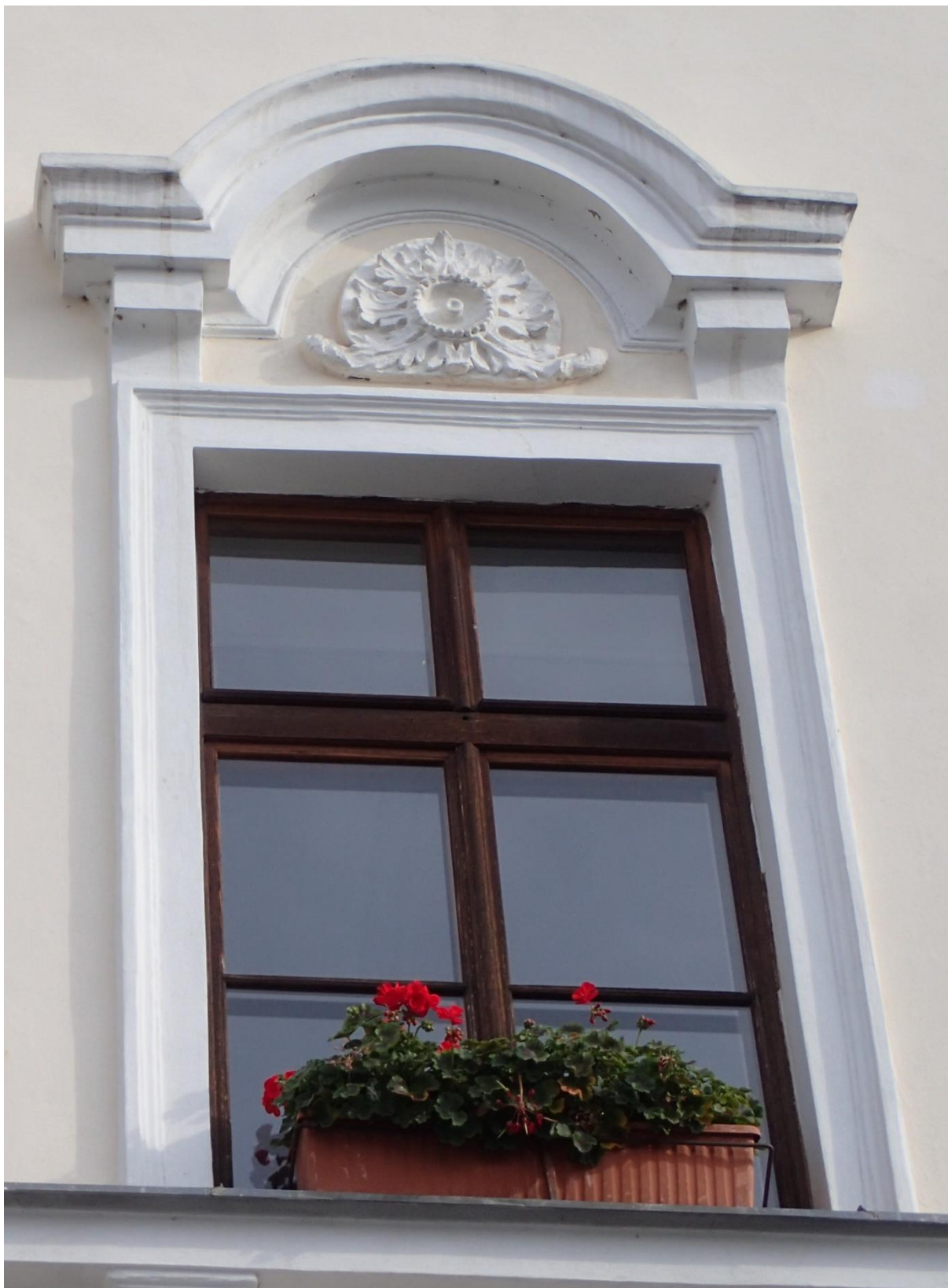
Obr. č. 23 Stav při průzkumu – okna /infocentrum/ 1. NP – vnější strana – celkový pohled Konstrukčně jsou okna v pořádku, povrchová úprava je dožilá. Barevný krycí nátěr se hlavně ve spodní části uvolňuje a odpadá. Poutec je plochý bez výzdoby. Zasklení je na sklenářský tmel, který se lokálně uvolňuje a odpadá.
