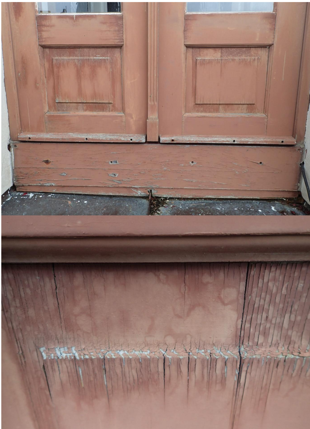
Obr. č. 8+9 Stav při průzkumu – dveře 2. NP – vnější strana – detail – spodní část Konstrukčně jsou dveře v pořádku, povrchová úprava je dožilá. Barevný krycí nátěr se hlavně ve spodní části uvolňuje a odpadá. Ve spojích je barva popraskaná. Dobře patrný je stav výplně a soklové části dveří.
