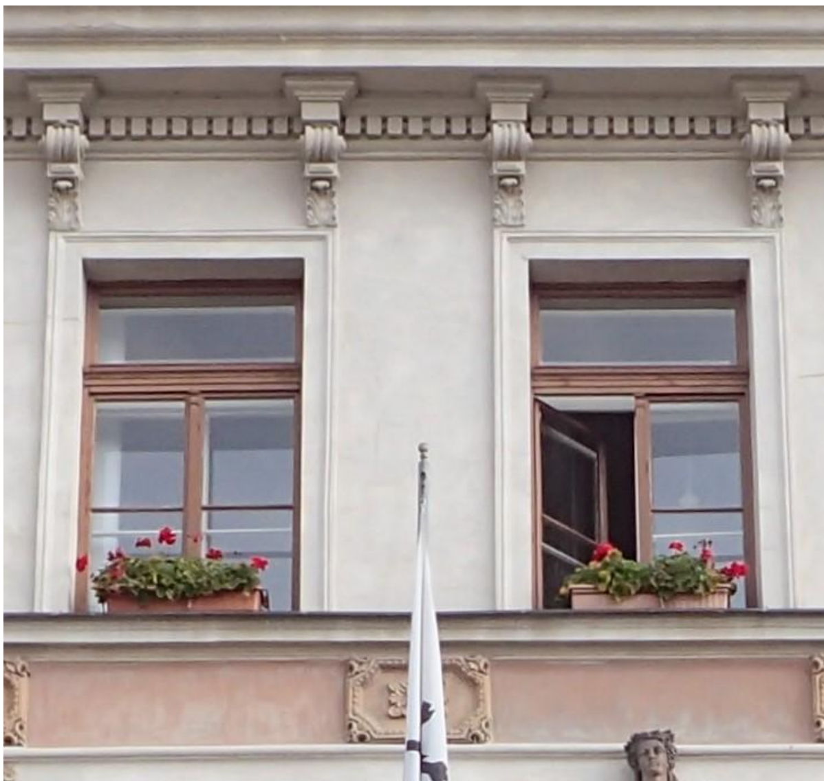
Obr. č. 13 Stav při průzkumu – okno 3. NP – vnější strana – celkový pohled Celkový pohled na okna z náměstí v 3. NP. Konstruktivně je okno v pořádku, povrchová úprava je dožilá. Barevný krycí nátěr se hlavně ve spodní části uvolňuje a odpadá. Stav je v podstatě shodný s ostatními okny a dveřmi v průčelí budovy na náměstí T:G:M.
