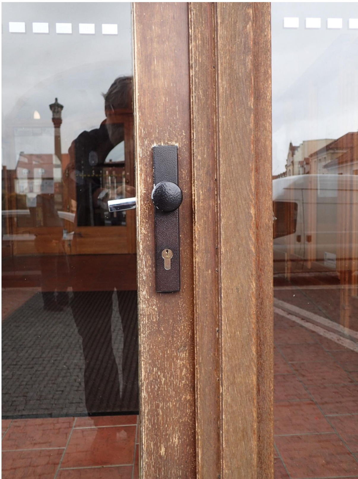
Obr. č. 20 Stav při průzkumu – dveře /infocentrum/ 1. NP – vnější strana – detail Konstrukčně jsou dveře v pořádku, povrchová úprava je dožilá. Barevná lazura se hlavně ve spodní části uvolňuje a odpadá. Kování je současné a funkční.
