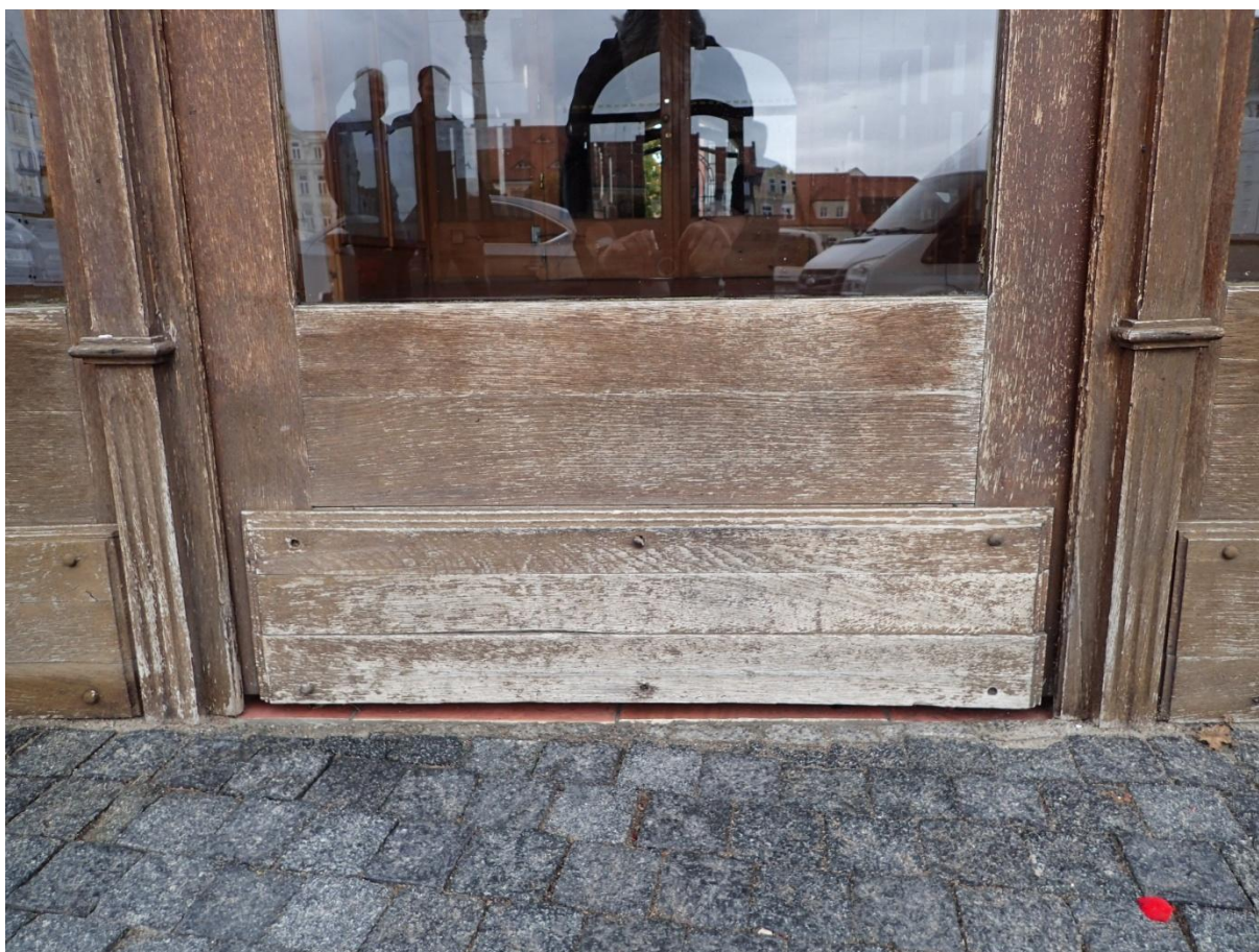
Obr. č. 21 Stav při průzkumu – dveře /infocentrum/ 1. NP – vnější strana – detail Konstrukčně jsou dveře v pořádku, povrchová úprava je dožilá. Barevná lazura se hlavně ve spodní části uvolňuje a odpadá. U okopových desek jsou narušené lepené spoje a jsou vypadané záslepky vrutů. Lepené spoje bude nutné obnovit a záslepky doplnit. Dožilý nátěr bude nutné celoplošně odstranit, aby bylo po nové povrchové úpravě docíleno jednotné barevnosti.
