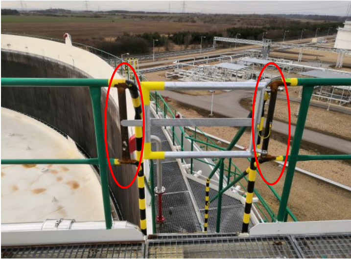
Obr. 3.9 Označená místa instalace
