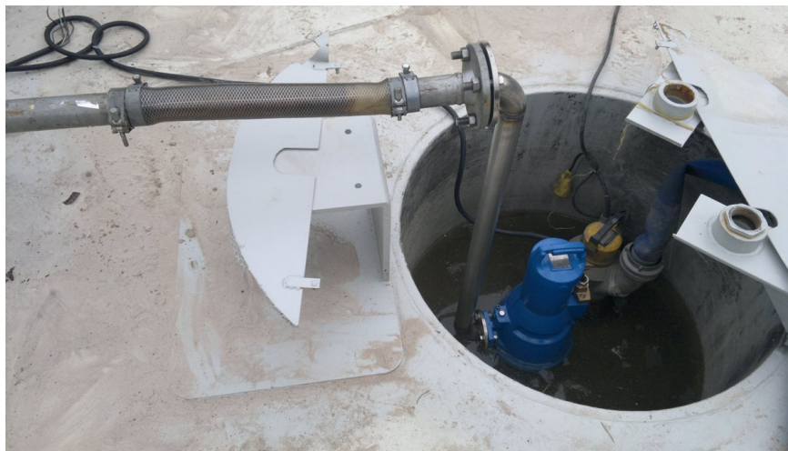
Obr. 4.5 První díl výtlačného potrubí odvodnění střechy
