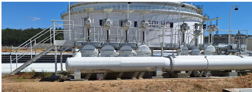
Obr. 2.5 Armatury rozdělovače a směšovače včetně přechodové lávky
