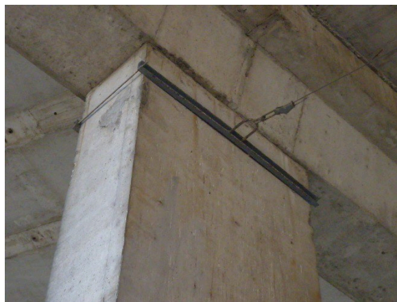
Obr. 28: Trakční vedení na mostním pilíři
