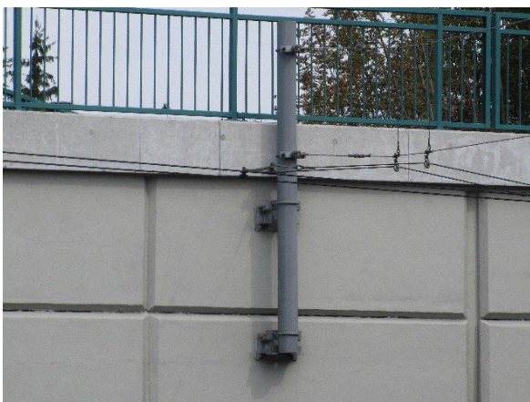
Obr. 27: Trakční vedení na zkráceném stožáru
