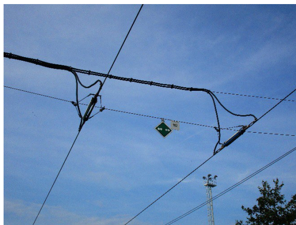
Obr. 41: Umístění návěstidla úsekového dělení
