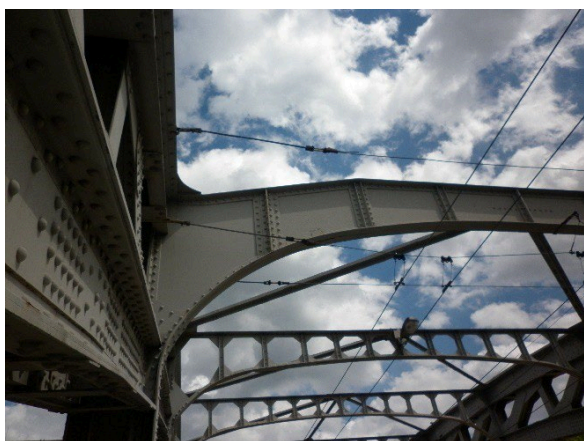
Obr. 25: Trakční vedení na mostní konstrukci
