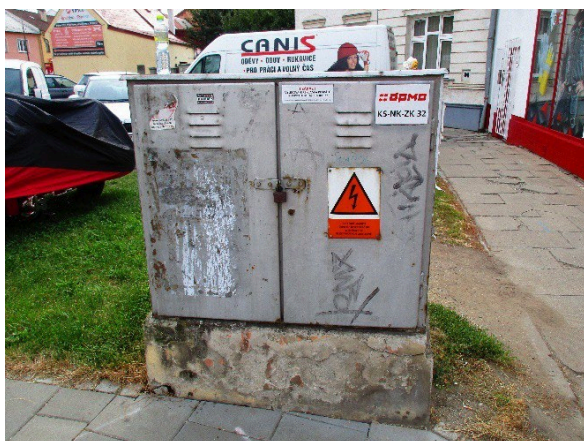
Obr. 50: Kabelová skříň – rozvaděč
