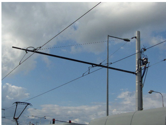
Obr. 42: Propojovací kabely na výložníku
