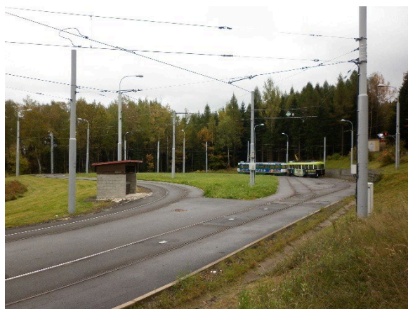
Obr. 4: Pevné kotvení řetězovkového vedení
