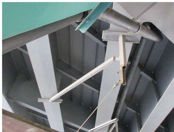
Obr. 20: Trakční vedení pod mostem
