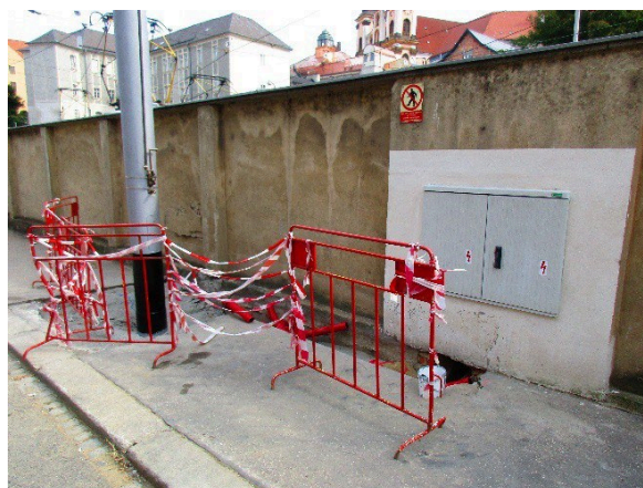
Obr. 51: Rozvaděč ve zdi
