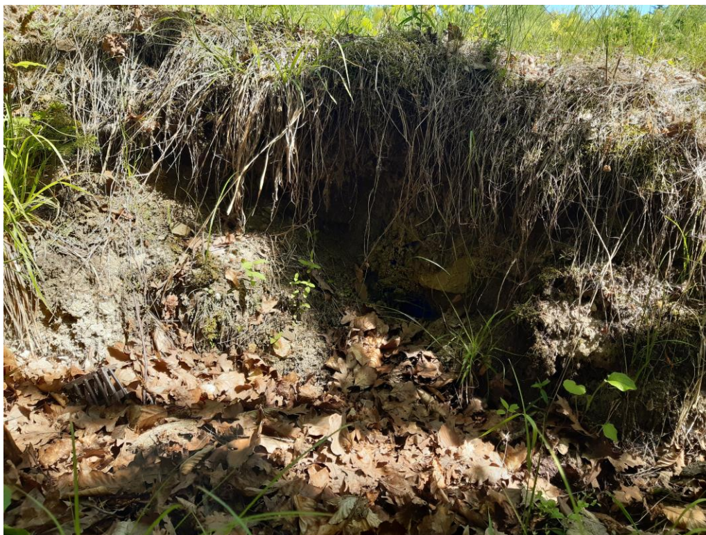
Obr. 3 - Lokální poškození vzdušného líce
