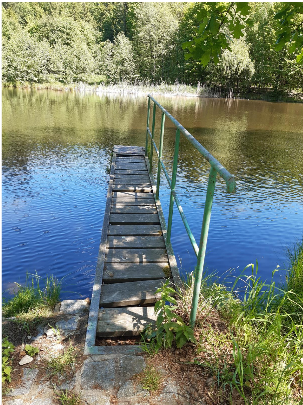
Obr. 4 - Požerák s poškozenou lávkou
