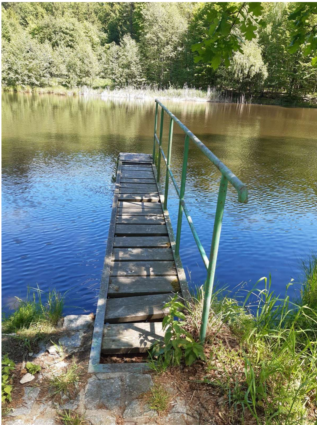
Obr. 4 - Požerák s poškozenou lávkou
