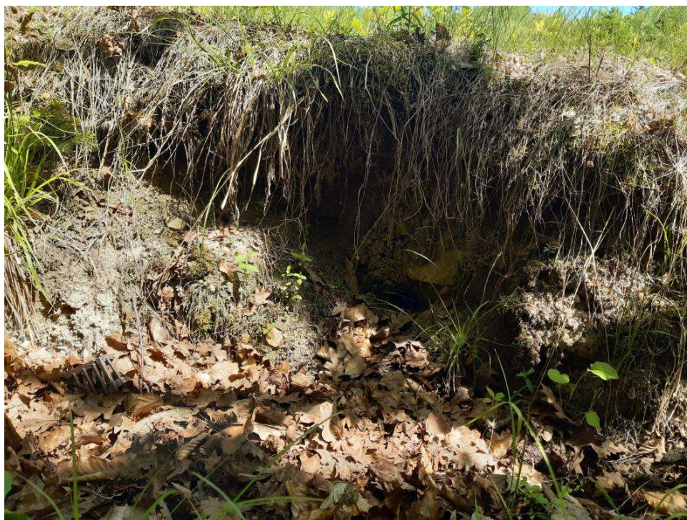
Obr. 3 - Lokální poškození vzdušného líce
