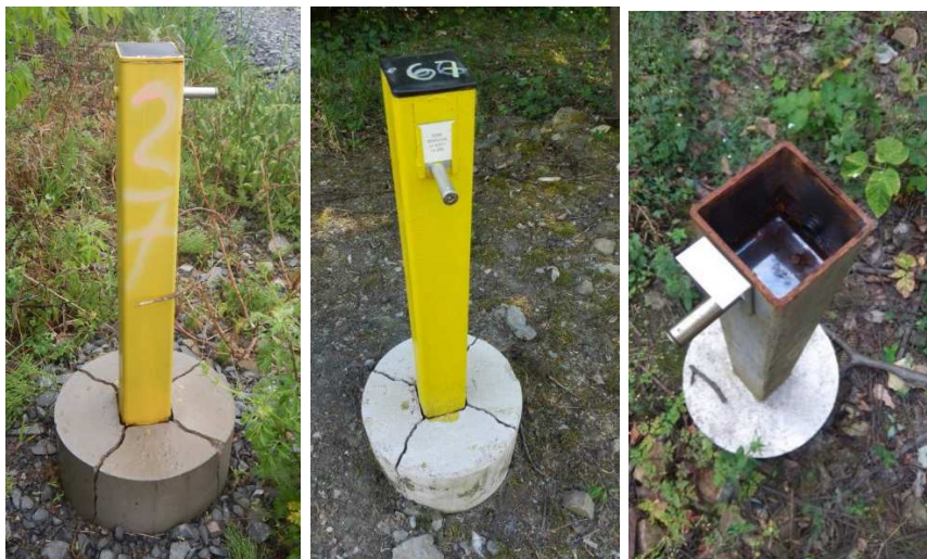
Obrázek 19 Popraskané betonové základy zajišťovacích značek ŽPSV
