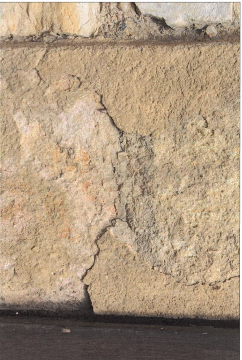
Degradace hmoty pískovce a druhotných tmelů.
