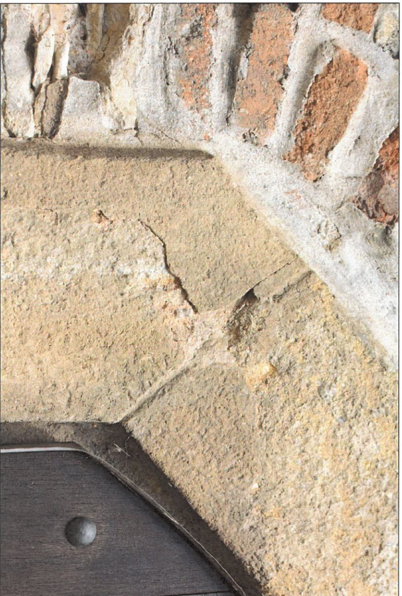
Degradující druhotný tmel rohu a spárování.
