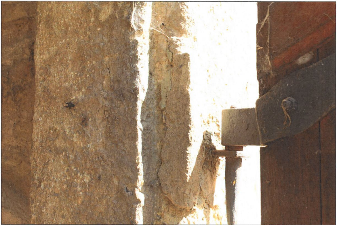
Osazení pantu a odlučující se druhotný tmel.
