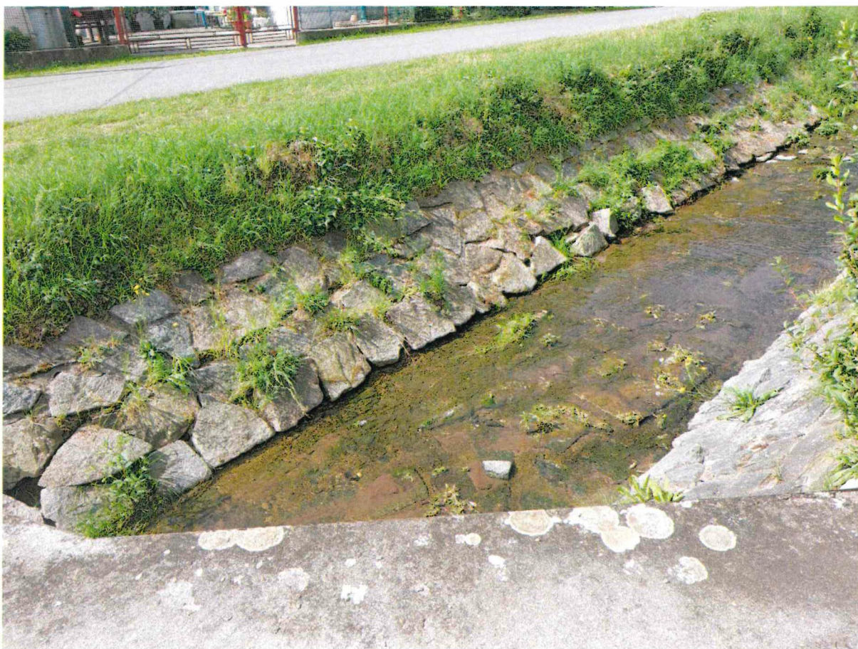
Foto č.5 Pohled z mostku proti proudu – na p.b. podplavená pata a poškozené spárování – ř.km 0,4-0,5
