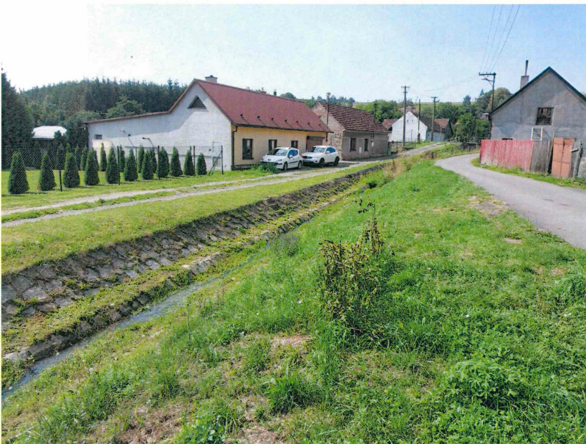
Foto č. 2: Pohled z l.b. na p.b. – v předmětném úseku historického vybřežení 0,00-0,12 v zástavbě
