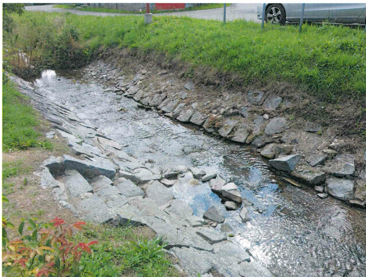
Foto č. 4 pohled z p.b. proti proudu na podplavenou patu a poškození podélného opevnění – ř.km 0,4
