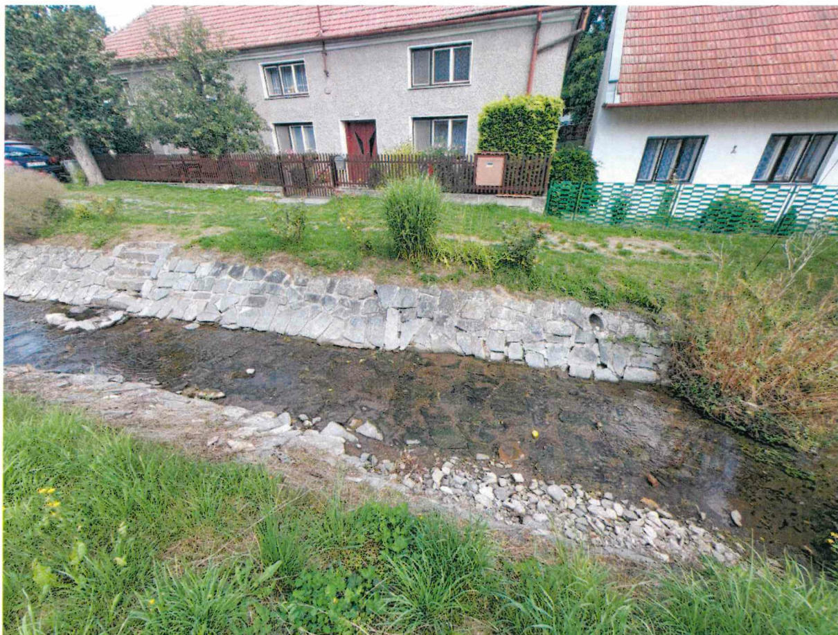
Foto č. 3 Pohled z p.b. do koryta na degradované opevnění se schody – ř.km 0,34
