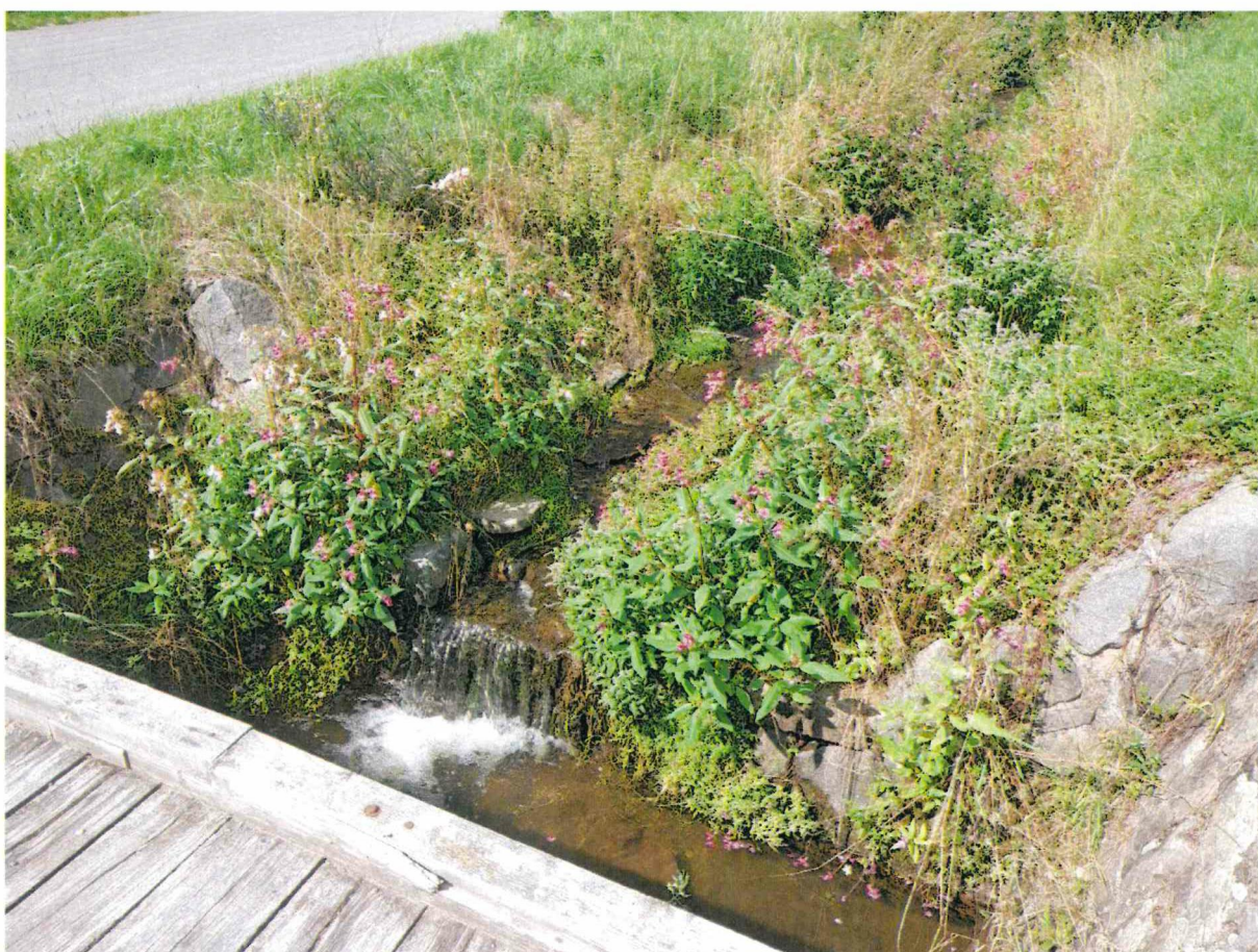
Foto č. 6: Pohled na stupeň v ř. km cca 0,58 s patrnou degradací spárování a s vegetací (sedimenty)
