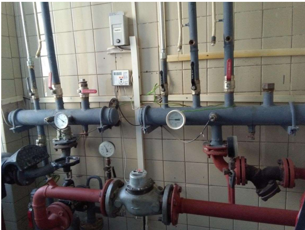
Obr. č. 20 - Rozdělovač topné vody
