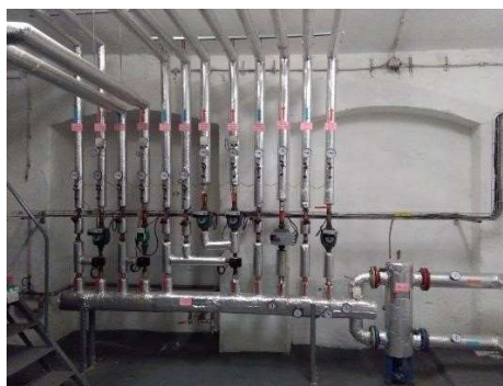
Obr. č. 4 – Kotelna hlavní budova
