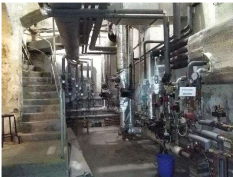
Obr. č. 3 – Výměňková stanice
