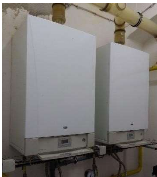
Obr. č. 3 – Kotelna hlavní budova
