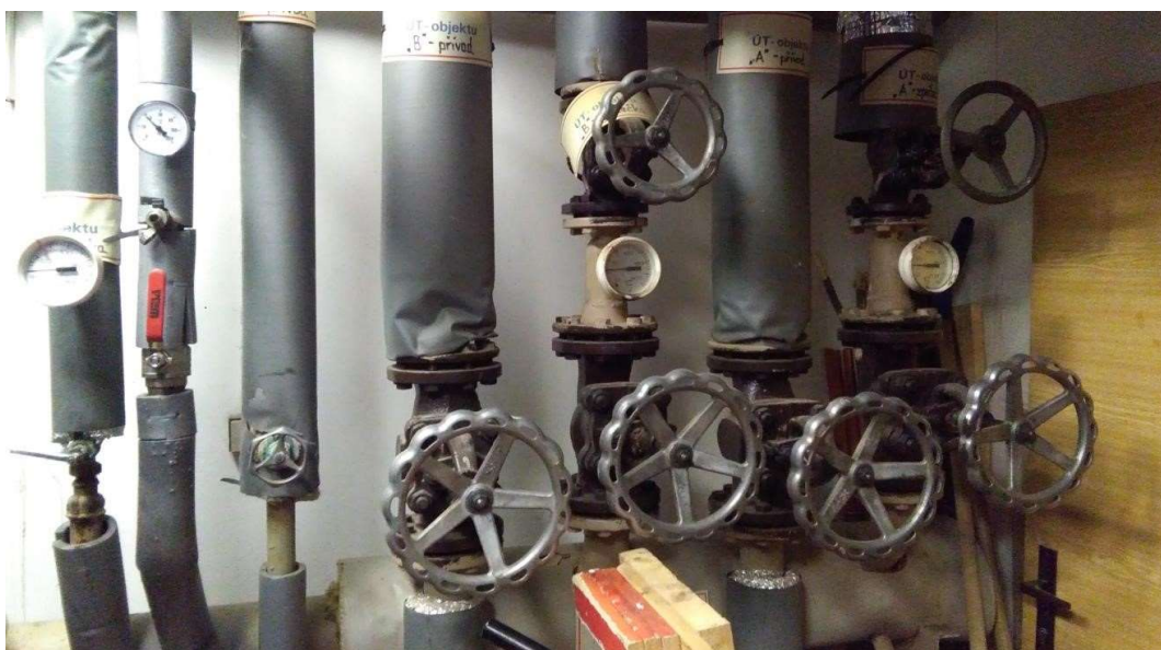
Obr. č. 53 - Rozdělovač topné vody
