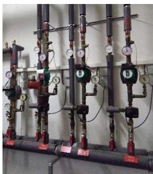
Obr. č. 5 – Kotelna budova 18A
