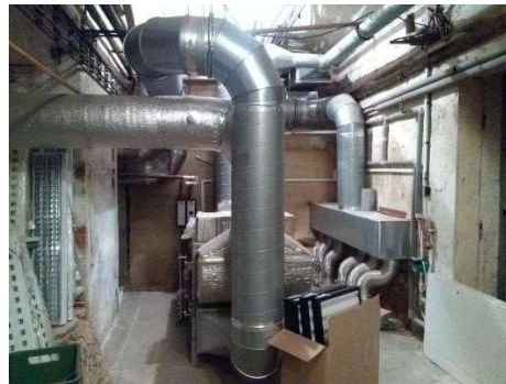
Obr. č. 4 – Vzduchotechnika
