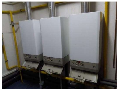
Obr. č. 6 – Kotelna budova 18A
