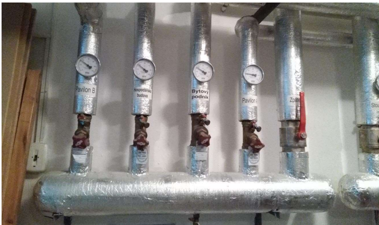
Obr. č. 13 - Rozdělovač topné vody
