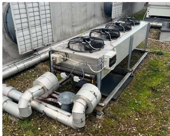
Obr. č. 8 – VZT na střeše objektu
