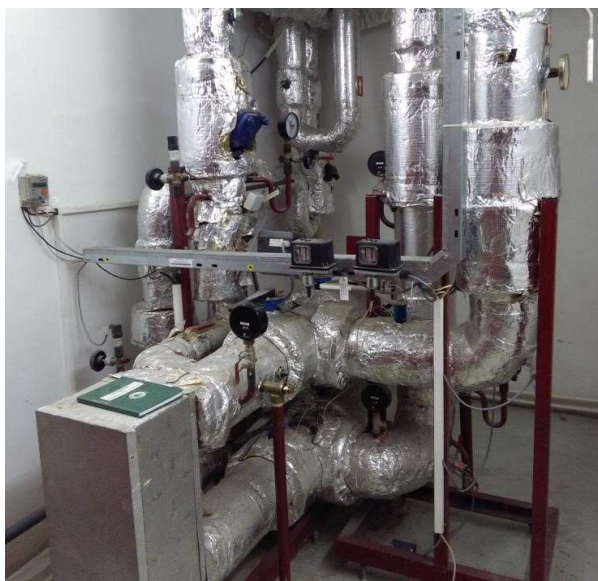
Obr. č. 5 – Výměňíková stanice
