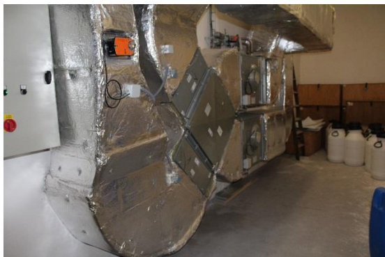
VZT 2 - REMAK – celkový pohled
