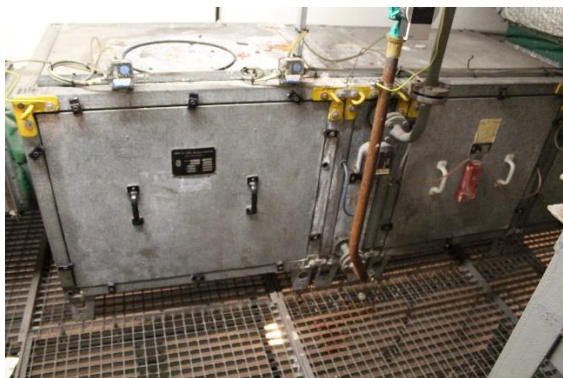
VZT pro havarijní větrání kotelny A
