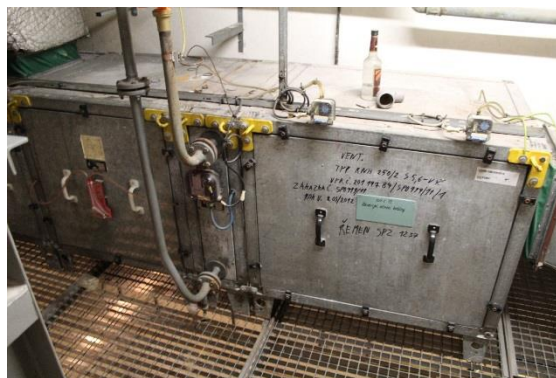
VZT pro havarijní větrání kotelny B
