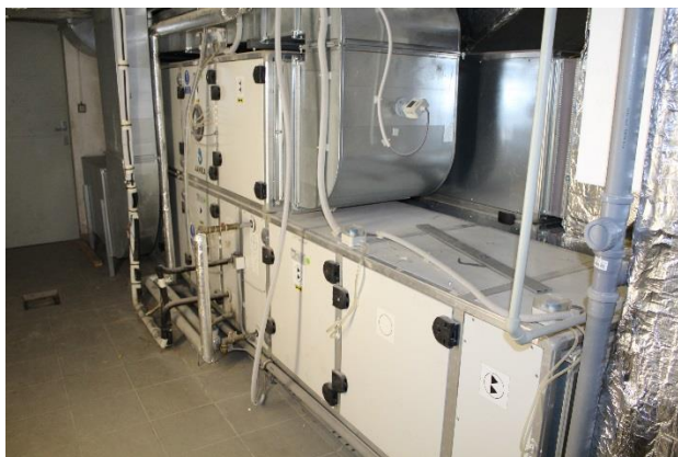
VZT ve strojovně v 1. PP
