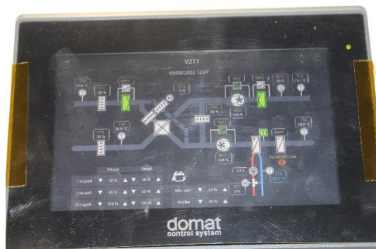
Řídicí systém VZT jednotek pro posluchárny
