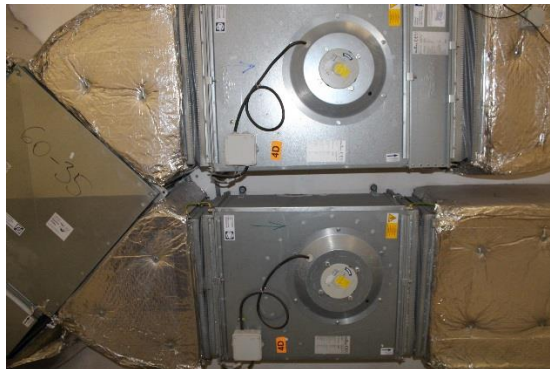
VZT 2 - REMAK - ventilátorové komory
