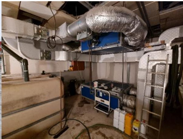
Obrázek 87: VZT jednotka v technické místnosti
