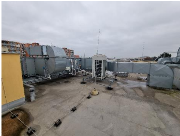
Obrázek 45: VZT jednotky a chlazení na střeše pavilonu E
