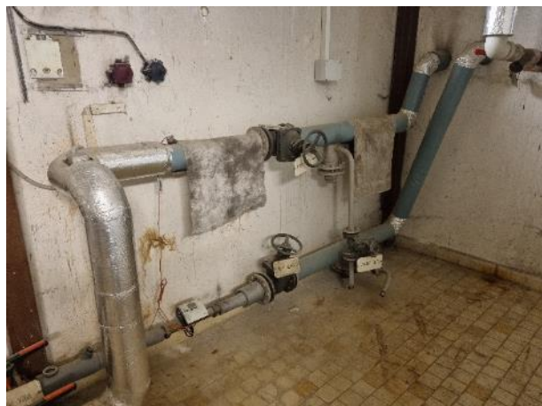
Obrázek 85: Přívod topné vody
