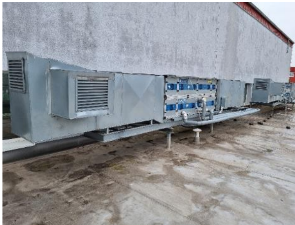
Obrázek 86: VZT jednotky na střeše
