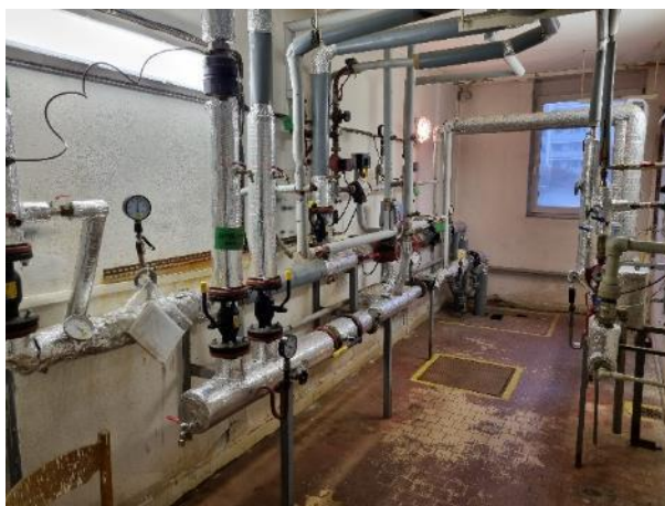
Obrázek 7: Předávací stanice v č.p. 638
