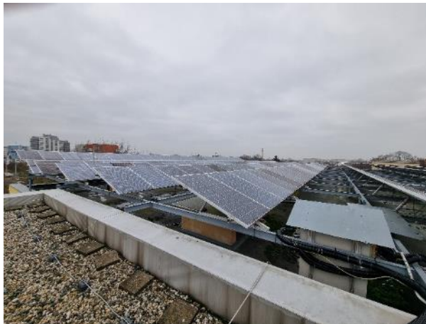
Obrázek 47: FVE na střeše objektu C
