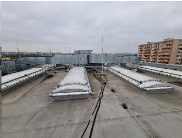
Obrázek 46: VZT jednotky na střeše objektu D
