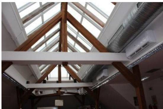
Obrázek 21: Větrání + chlazení podkroví
