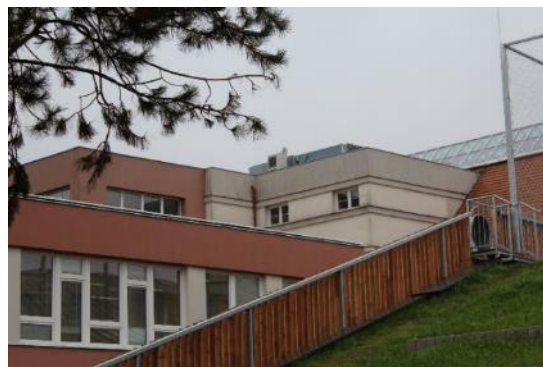
Obrázek 22: Větrací VZT jednotka + chlazení
