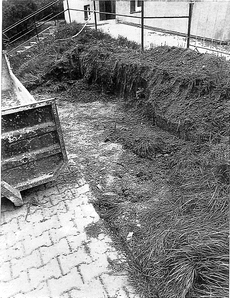
Sibiřská 60 (chybějící základy stanoviště komunálního odpadu)
