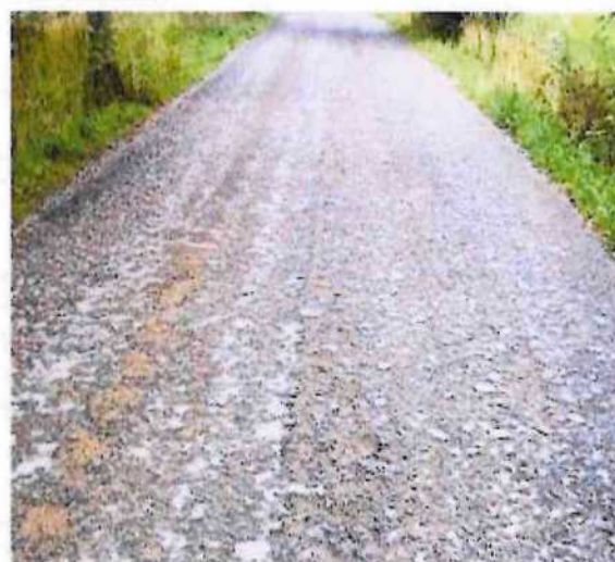
Hlubková koroze téměř přes celou šířku vozovky.
