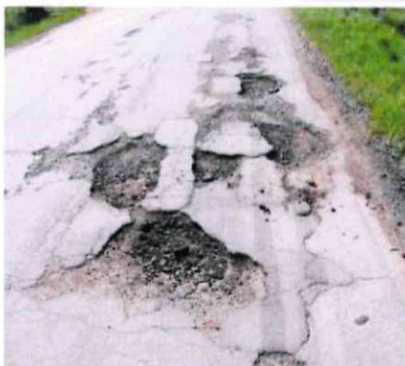
Spojování jednotlivých výtluků a postupný rozpad asfaltových vrstev.
