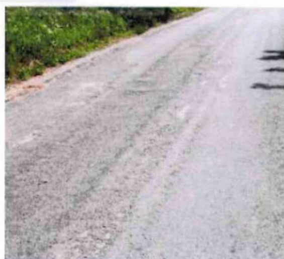
Postupná ztráta kameniva z nátěru.
