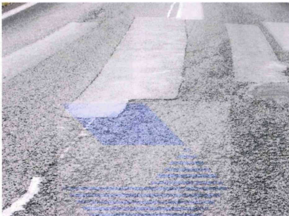
Hlubková koroze v AB krytu
