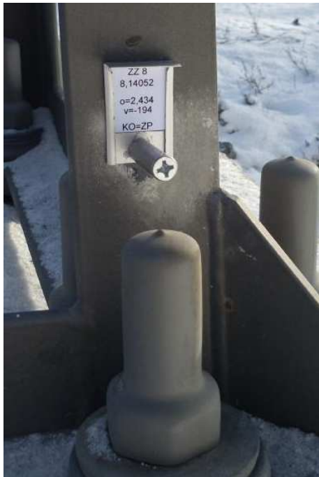
Obrázek 9 Konzolová značka na podpěře trakčního vedení
