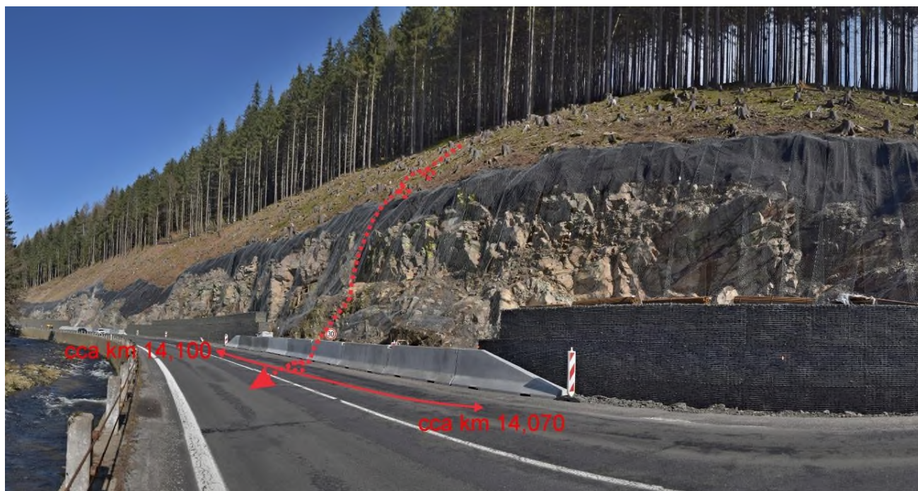
Foto 3 Úsek cca km 14,070–14,100 chráněný mobilními betonovými svodidly. V případě jejich odstranění budou mít skalní objekty uvolněné zpoza hrany zářezu potenciál k transportu do prostoru silnice. Výška sanovaného zářezu v kombinaci s pozicí krajnice silnice při úpatí má v současnosti potenciál k překonání mobilního svodidla s výškou cca 1,2 m, jak naznačuje tečkovaná křivka.
