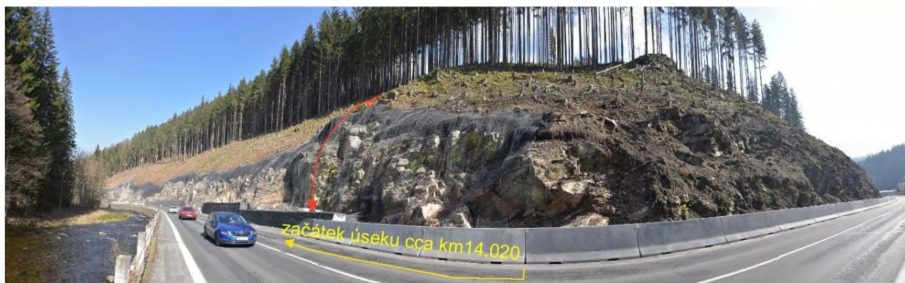
Foto 1 Přibližný začátek předmětného úseku km 14,020–14,411. Červená křivka naznačuje pravděpodobnou trajektorii pohybu skalního objektu uvolněného za hranou sanovaného zářezu v části s gabionovou zdí (viz foto 2).
