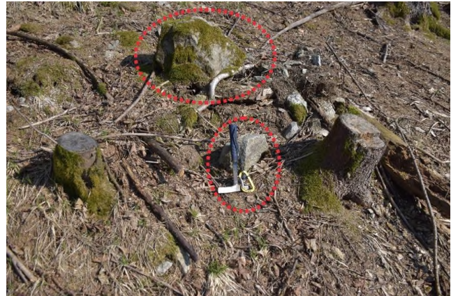
Foto 7 V tečkovaných elipsách jsou zvýrazněny skalní objekty polyedrického tvaru umožňující odvalování po svahu, ležící volně na svahu několik metrů za hranou sanovaného zářezu v cca km 14,295 (viz foto 10).
