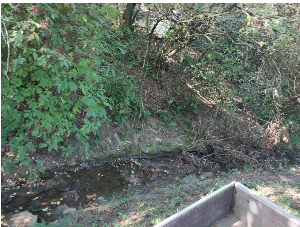
6 Současný stav koryta VT Žopka v km 1,86 (foto kamenné dlažby, chybějící patní spára a dnová eroze)
