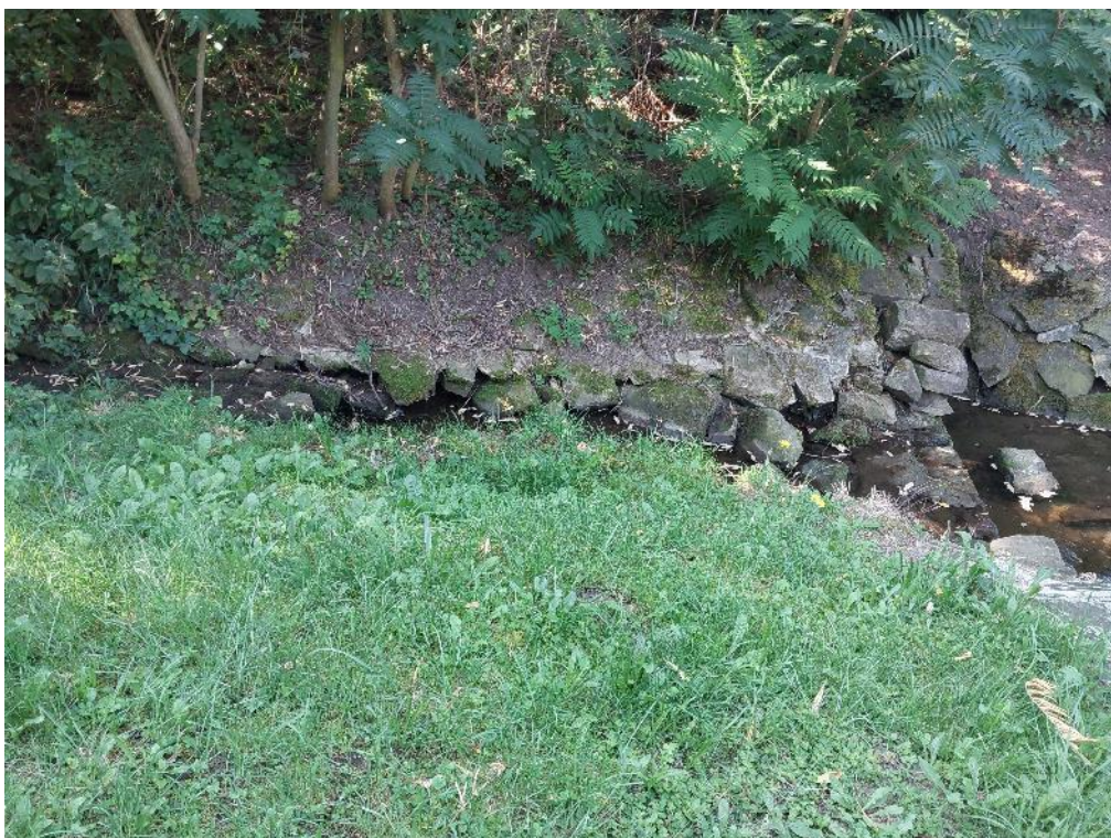
5 Současný stav koryta VT Žopka nad stupněm v km 1,84 dnová eroze nad stupněm
