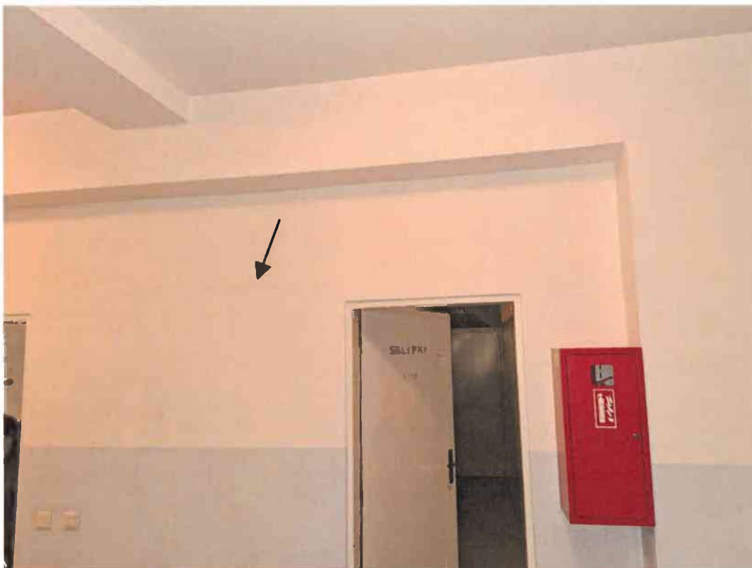
Foto 01 – pohled na vodorovnou trhlinu v příčce na hlavní chodbě od výtahu
