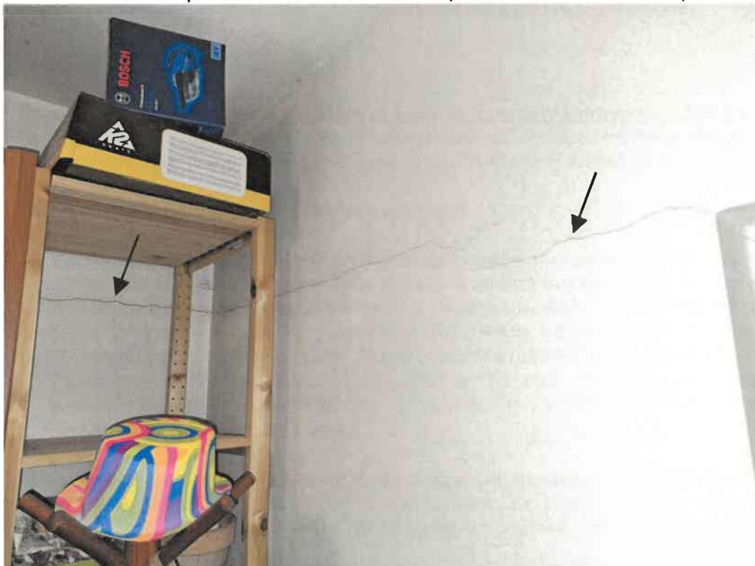
Foto 02 – pohled na trhlinu ze strany navazujícího bytu – trhlinu přechází do příčky mezi bytem a sklepním prostorem
