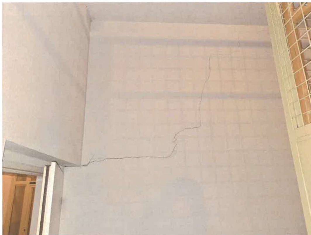
Foto 03 – pohled na trhlinu v dělicí stěně ze strany sklepního prostoru
