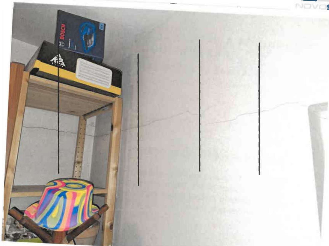
Foto 06 – schéma opravy trhliny sešitím helikální výztuží ze strany bytu
