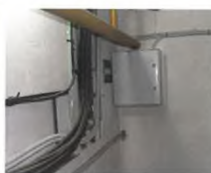
plastový rozvaděč cca 500x430x210mm
