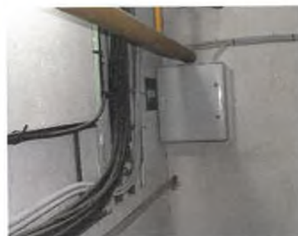
plastový rozvaděč cca 500x430x210mm
