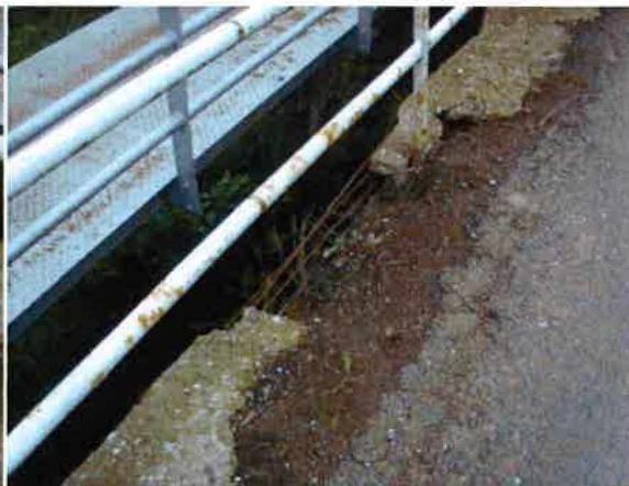
úplně rozpadlá římsa na pravé straně mostu
