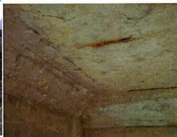
obnažená zkorodovaná výztuž na pohledu NK
