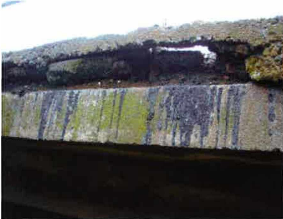
hloubkově rozpadlá nadbetonovaná římsa vpravo
