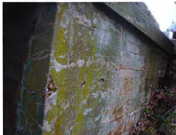
podélné trhliny a hloubkově degradovaný beton křídla na konci mostu vpravo
