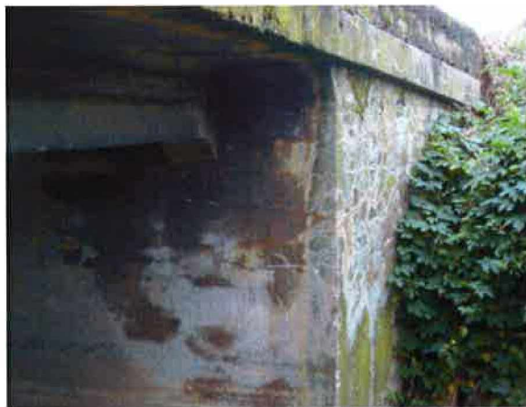
praskliny na čele a boku opěry a křídla na zač.mostu vlevo
