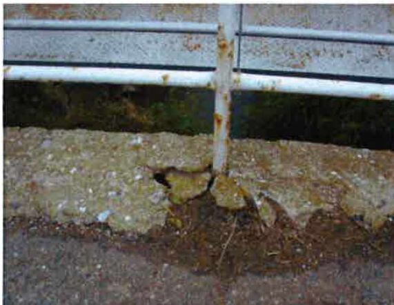
rozpadlý beton římsy vpravo
