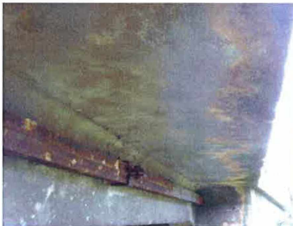
vápenité inkrustace na podhledu NK vlevo
