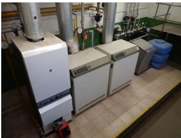
Obr. 187: Příprava TV, kotle, doplňovací zařízení
