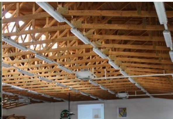
Obr. 143: Osvětlení velkého sálu – Technologická hala
