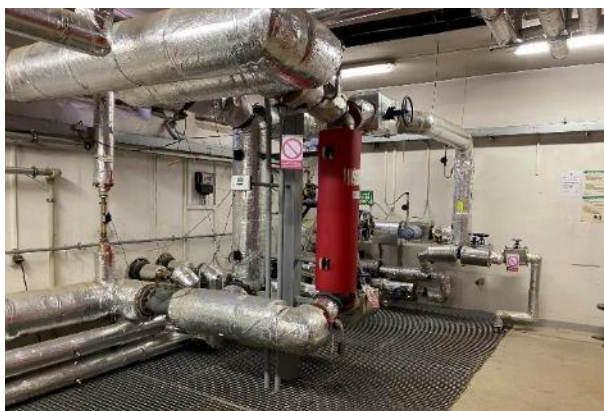
Obr. 169: Přívod páry a výměníky tepla
