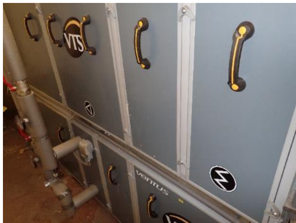
Obr. 118: VZT jednotka pro kuchyni
