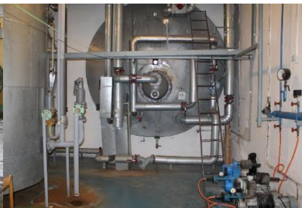
Obr. 133: Akumulační zásobník interiér
