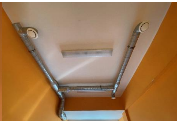
Obr. 173: Zářivkové osvětlení chodba – P2
