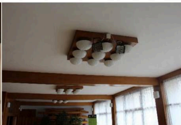
Obr. 88: Osvětlení sál - přístavba
