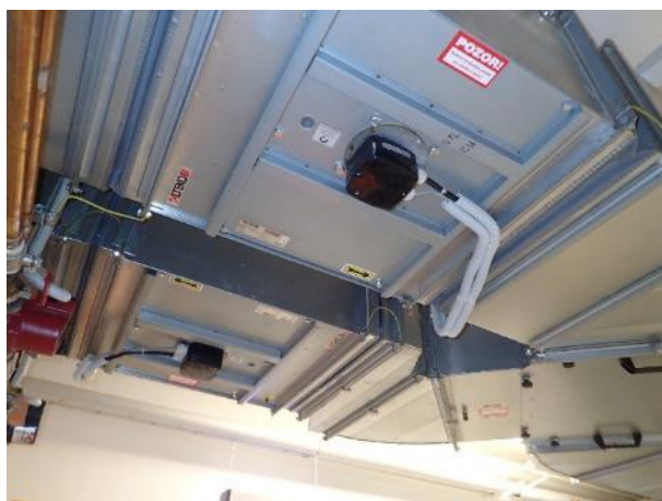
Obr. 45: VZT jednotka pro kuchyni
