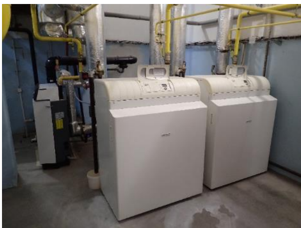
Obr. 106: Kotelna „A“, K2+K3
