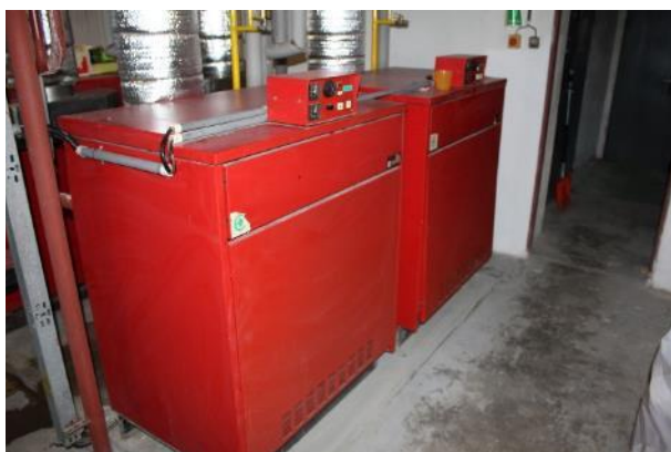
Obr. 33: Hlavní plynová kotelna
