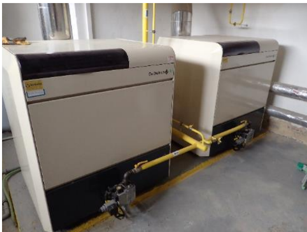
Obr. 43: Kotle De Dietrich
