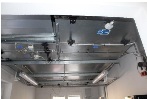
Obr. 98: VZT pro větrání kuchyně
