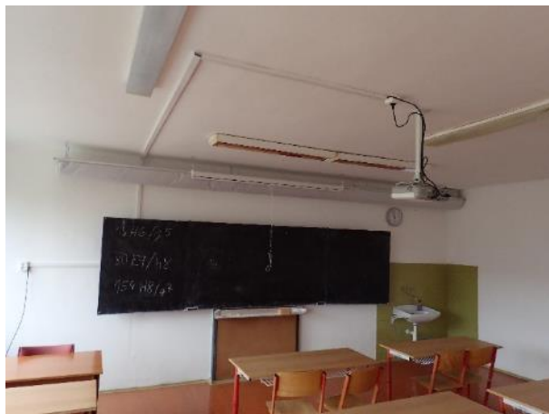
Obr. 162: Textilní vzduchovod nad tabulí (přívod)
