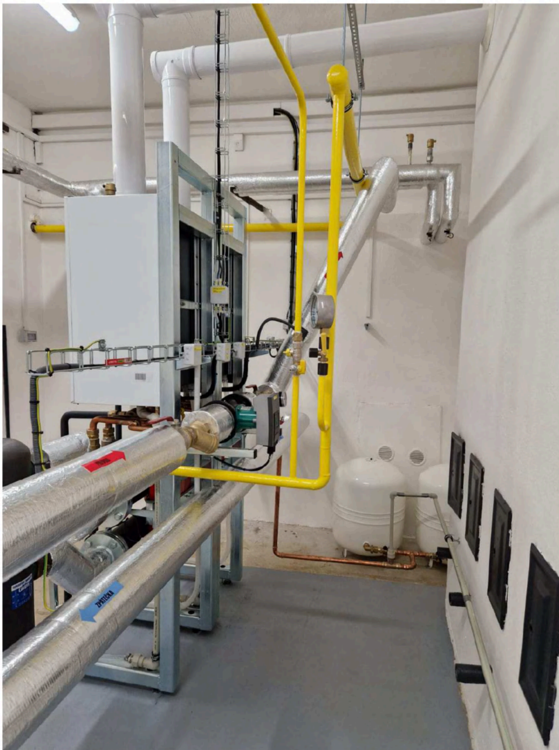
Obrázek: V kotelně (modernizace 09/2023) je nyní tedy 1 samostatný okruh pro vytápění otopnými tělesy osazený za kotli „novým „ čerpadlem WILO Yonos MAXO 50/0,5-8, 230V, 10-305W el.. Zde na zpátečce bude osazen TV TA STAD DN40.
