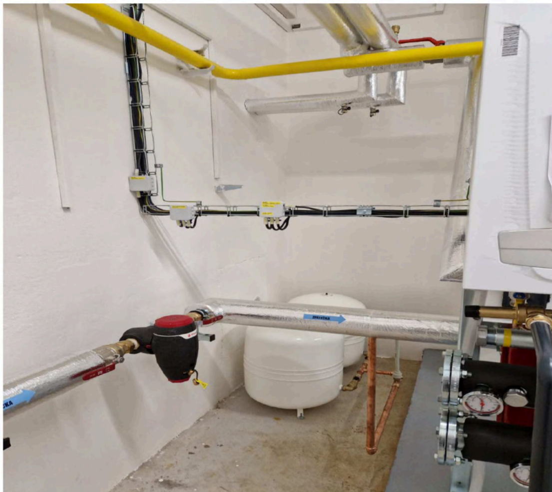
Obrázek: V kotelně (modernizace 09/2023) je nyní osazen magnetický filtr FLAMCO 11103- XStream Clean (DN 32) G 1 1/4 F“ s magnetem a izolací - sestava
