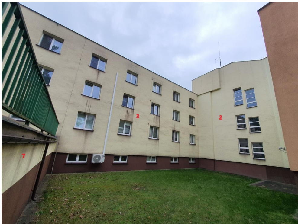
budova C – severovýchodní strana (označeno č.3), krček – jihovýchodní strana, týká se pouze krčku mezi budovou A, C (označeno č.2), stěny přilehlých garáží u budovy C (označeno č.7), nátěr zábradlí a oplechování terasy nad garážemi (délka zábradlí cca 44,0m, výška zábradlí 0,97m)
