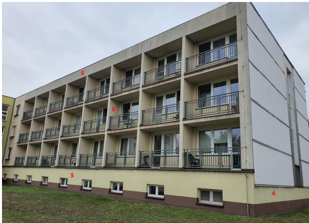
budova C – jihovýchodní soklová část budovy (označeno č.4), jihovýchodní strana s lodžii (označeno č.5), nátěr 24 ks zábradlí a oplechování lodžii (délka zábradlí cca 3,5m, výška zábradlí 0,97m
