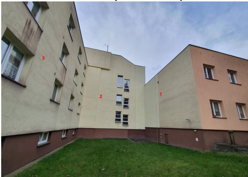
budova A – jihozápadní strana (označeno č.1), budova C – severovýchodní strana (označeno č.3), krček – jihovýchodní strana, týká se pouze krčku mezi budovou A, C (označeno č.2)
