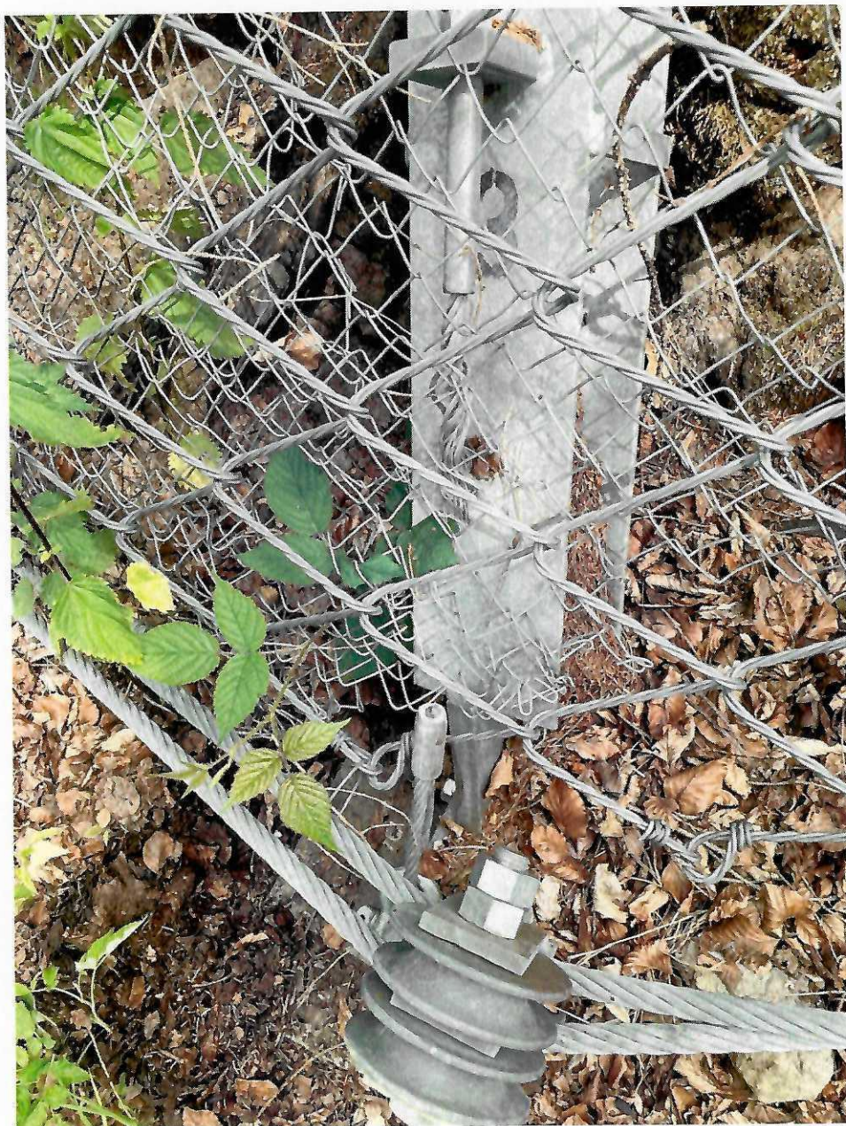
Poškozený sloup DB č.3 určený k výměně.
