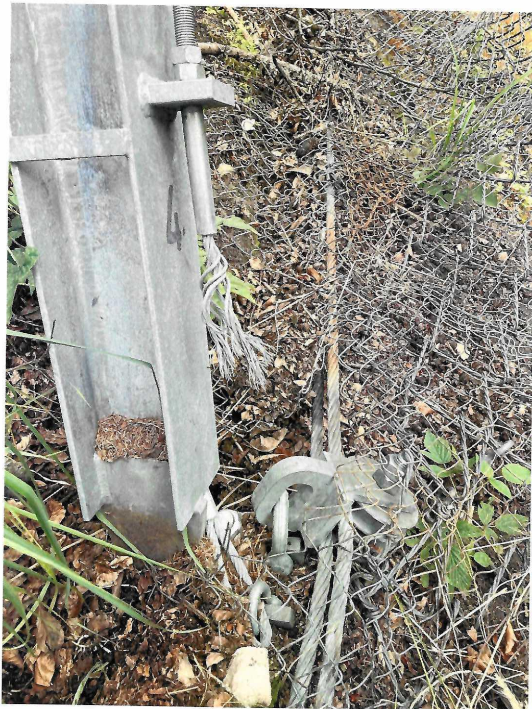
Poškozený sloup DB č.4 určený k výměně.
