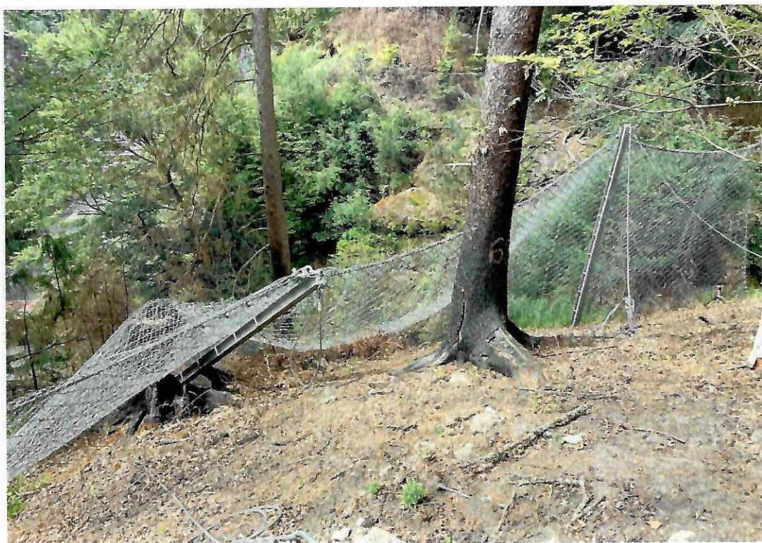
Sloup DB určený k výměně.
