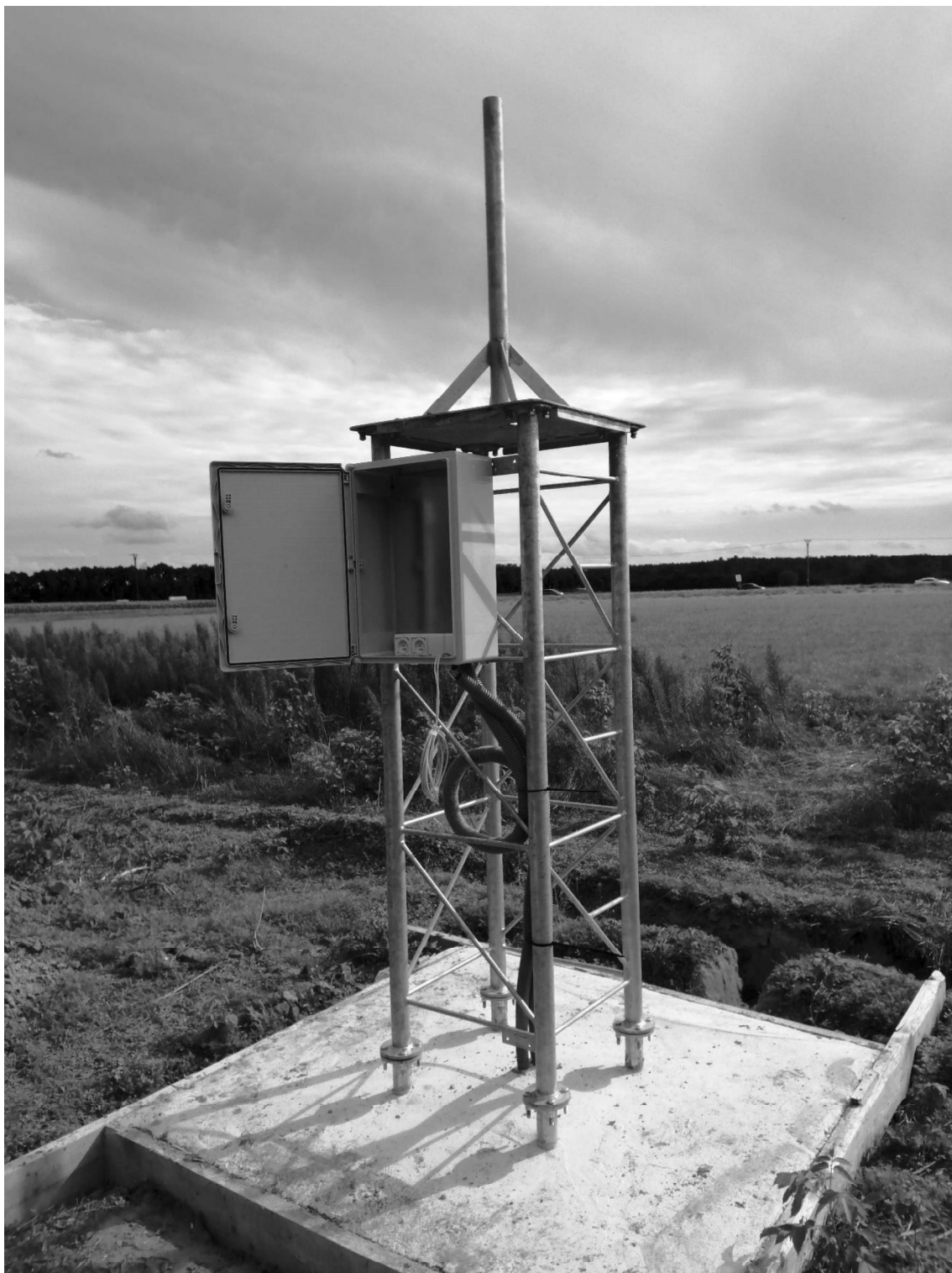
Obr. 1: Čtyřboký příhradový stožár s nástavcem osazený v betonovém základu.
