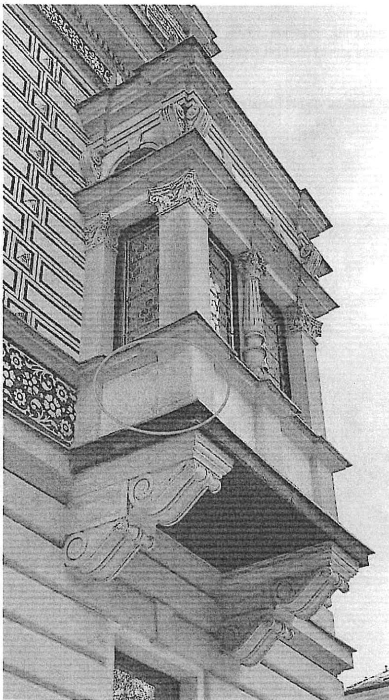
Arkýř budovy Římskokatolické farnosti Chrudim. Poškození vrstvy štuk.
