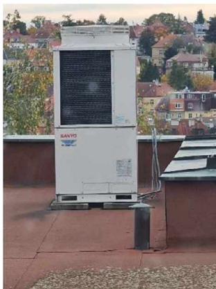
Terasa s umístěním venkovní jednotky
