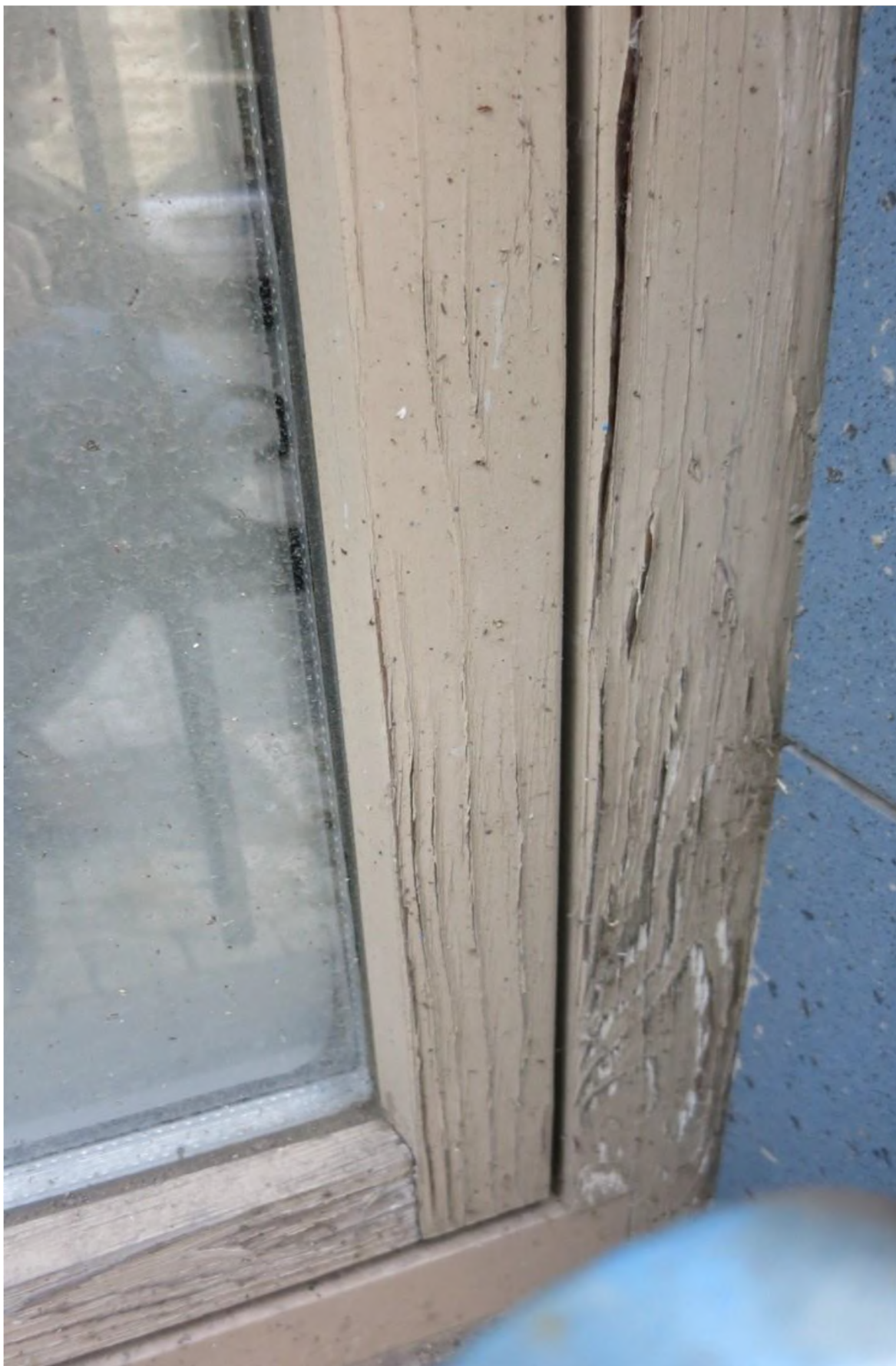
Detail poškození nátěrů a rámu okna – okno O2 přízemí uliční fasáda
