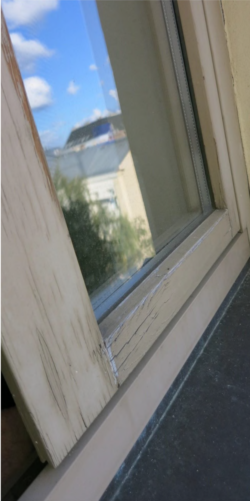
Foto typického poškození vnějšího povrchu okenního
