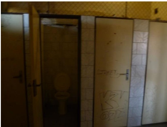
Současný stav WC
