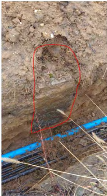
Obrázek 45 Ukázka vedení výkopu v bezprostřední blízkosti geodetického bodu - tím jsou souřadnice bodu zničeny
