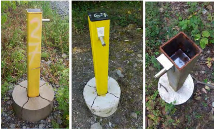
Obrázek 19 Popraskané betonové základy zajišťovacích značek ŽPSV
