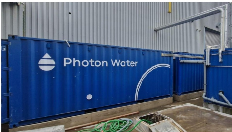
Ilustrační foto: Kontejnerová jednotka pro zpracování kalu z průmyslových odpadních vod (Valeo, Žebrák – realizace 2023).
