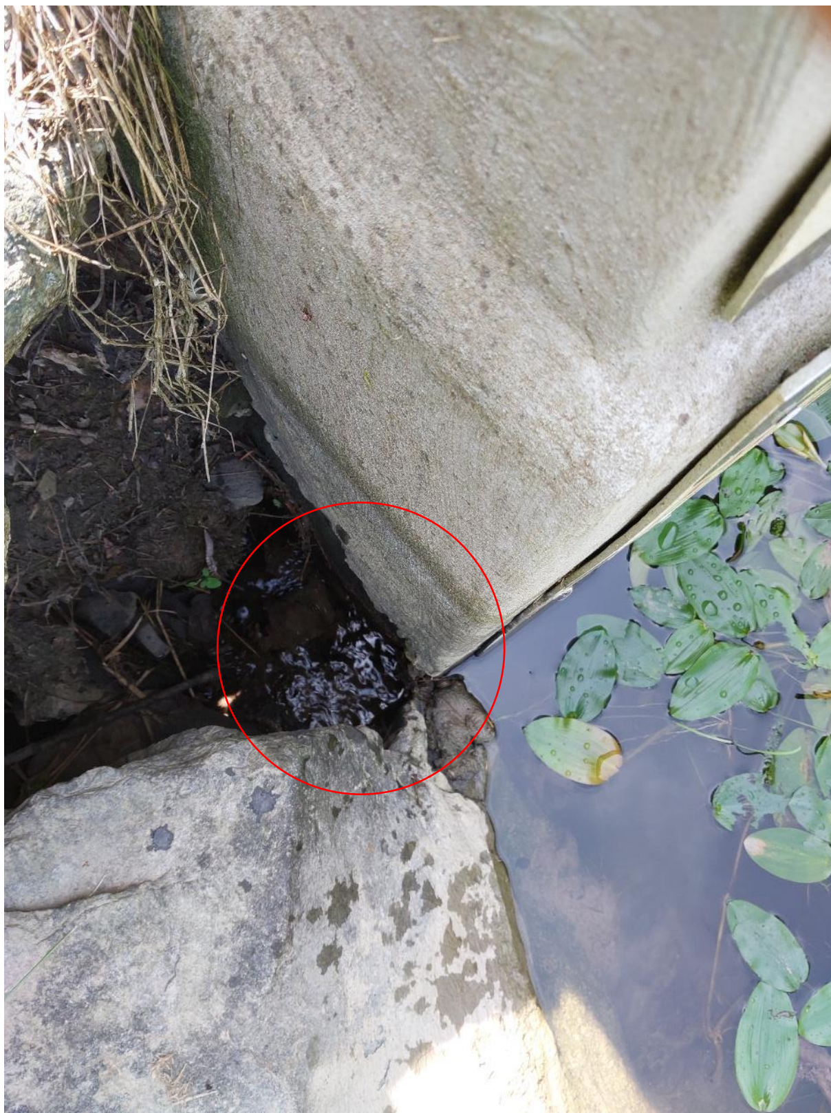
3 VN Hutě - zčeřená hladina v místě, kde voda obtéká požerák
