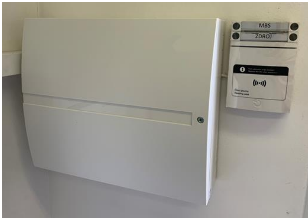
Obr. 9 JABLOTRON ústředna JA-107K a přístupový modul JA-114E
