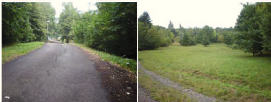
Obr. 4a, 4b: Vlevo: zátky na asfaltové komunikaci v prostřední části svahu ponkazují na menší dílčí sesouvání, spíše povrchové. Vpravo: celkový pohled na střední část svahu, která byla v rámci rekultivaci zřejmě opravena.
