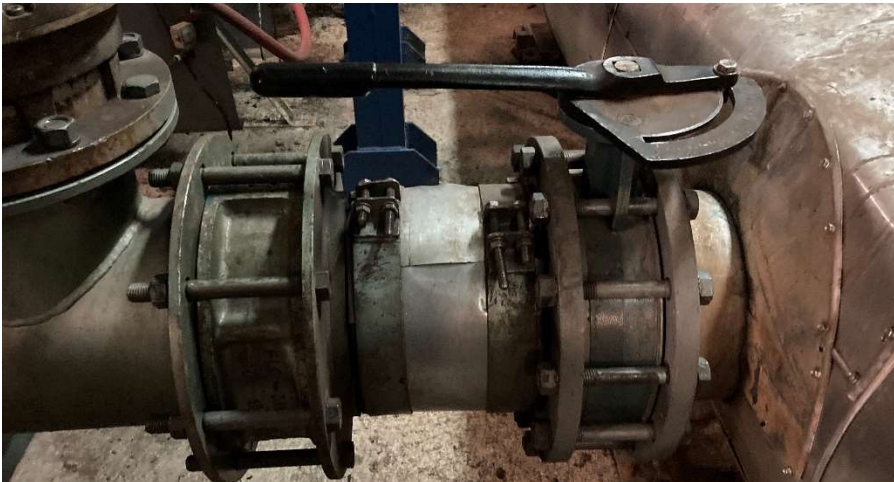
Připojení dmychadla č.2 provizorní manžetou, vpravo mechanická uzavírací klapka.
