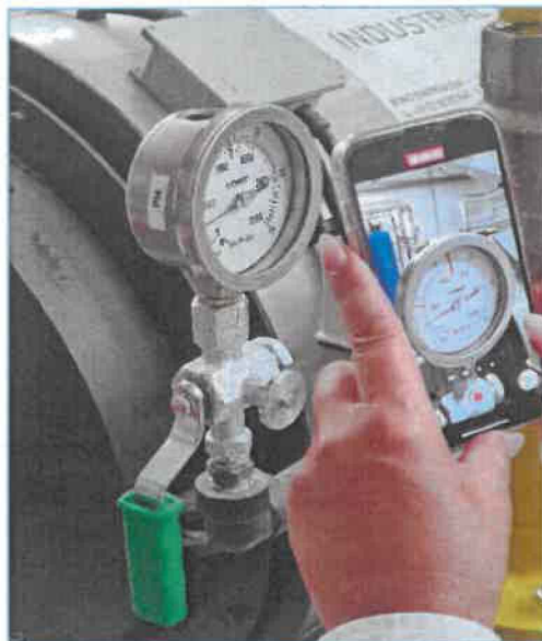
Obrázek číslo 3: Dokumentace poklesu tlaku páry na výstupu z parního vyvíječe na 2,5 bar
