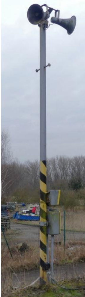
Sloup staničního rozhlasu se zpětným dotazem, ŽST Bohosudov
