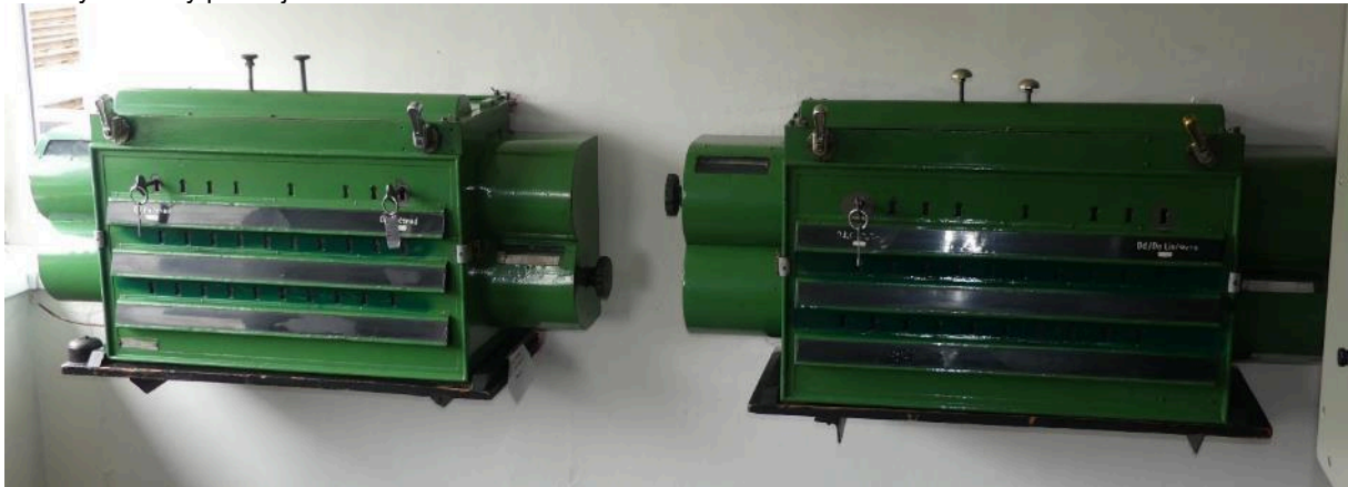
Klíčový bubnový přístroj 2 ks ze stavědla 2 ŽST Obrnice
