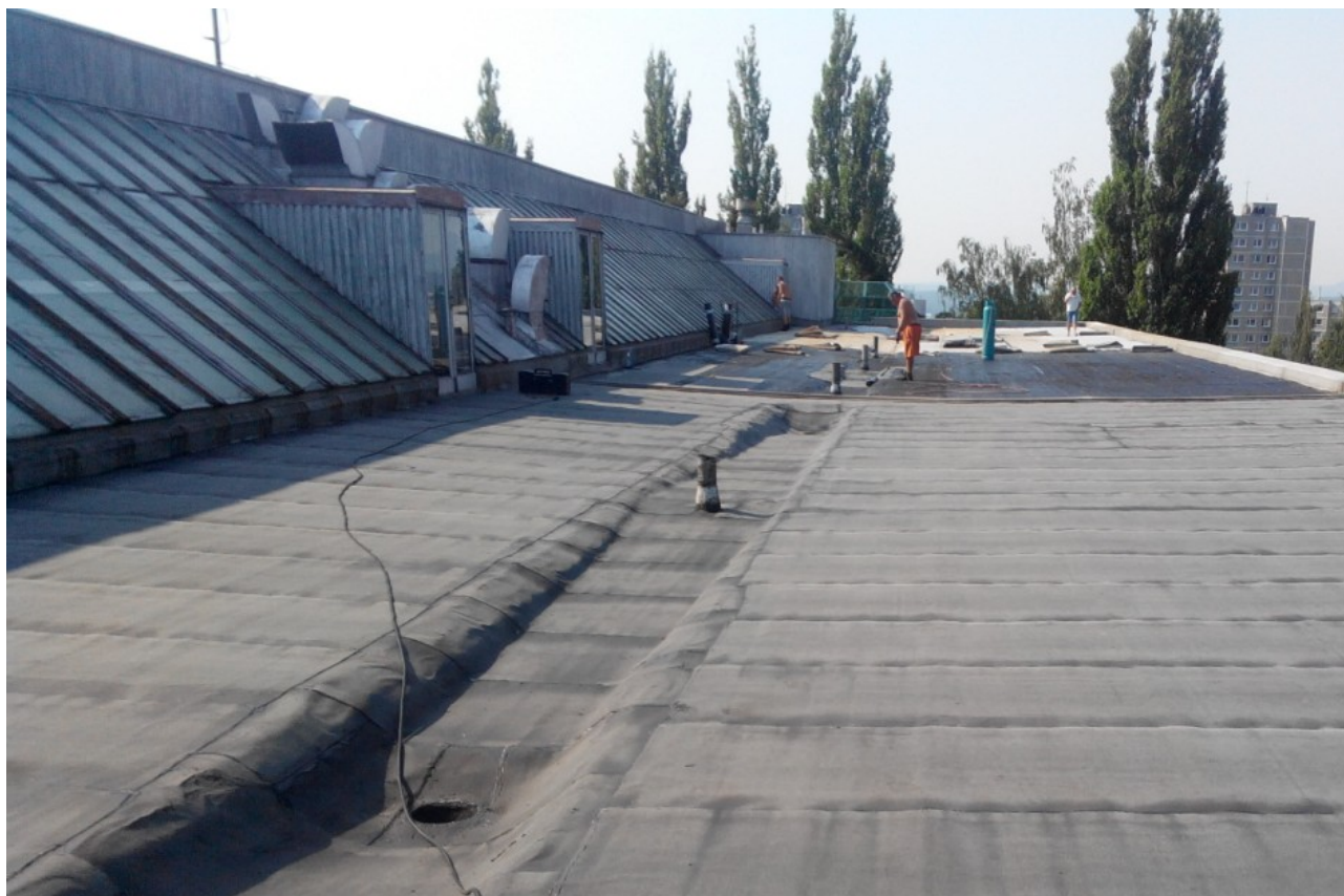
Vyústění výdechů VZT nad střechou pavilonů A1 a A2
