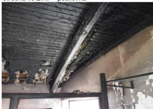
-poškození prohořením, zuhelnatěním
