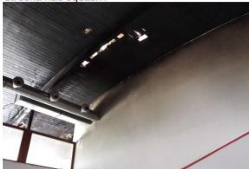
-poškození zuhelnatěním -prostupy zřízeny při hašení
