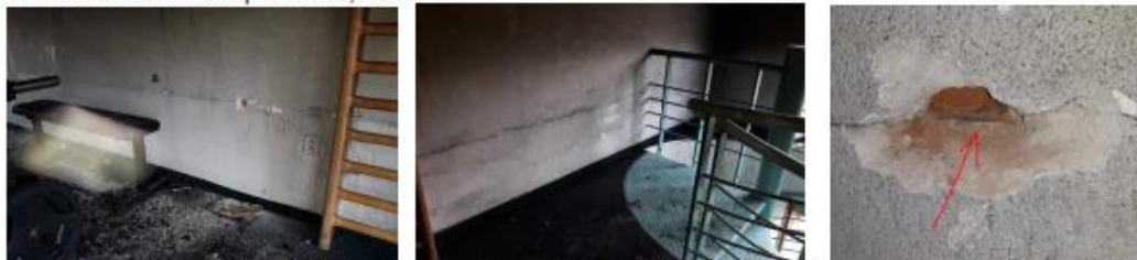
-vodorovná prasklina podél místnosti, sondou zjištěna ocelová pásnice tl.~5mm (? - důvod neznámý)
