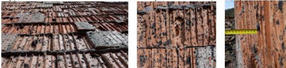
-vizuálně přímo poškozená zóna ~100mm
