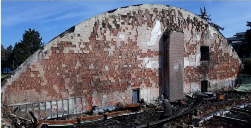
-celý povrch zasažen odpadááním krajních žeber tvarovek
