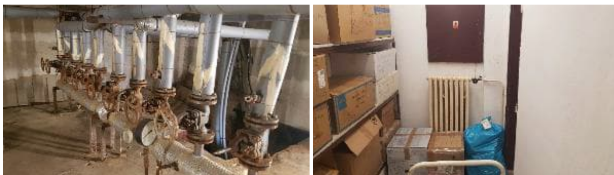
Obrázek 41 Pohled na nevyhovující R+S a OT bez TRV
