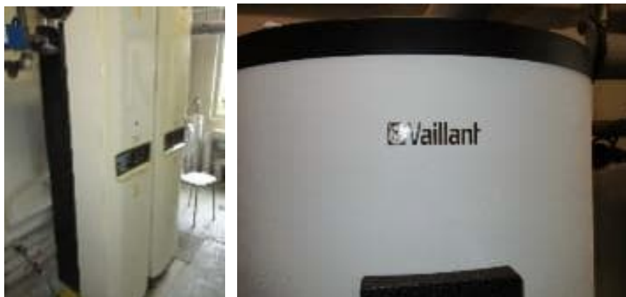
Obrázek 30 Lokální plynové kotle v obj. P a akumulční nádrž pro přípravu TV
