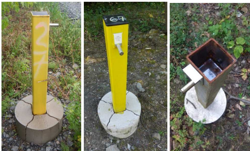
Obrázek 19 Popraskané betonové základy zajišťovacích značek ŽPSV
