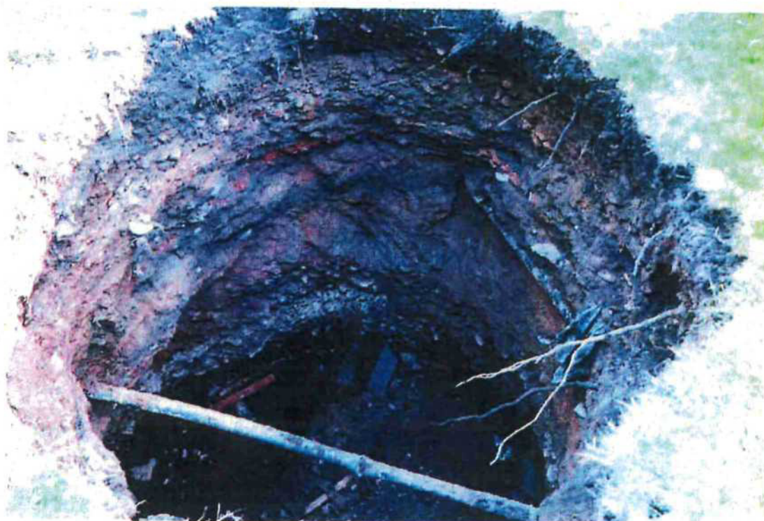
Pohled na propad východním směrem s patrným plynovým potrubím v boku na jižní straně
