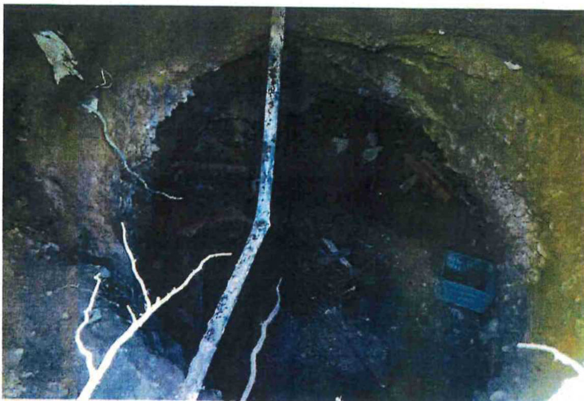
Pohled na dno propadu
